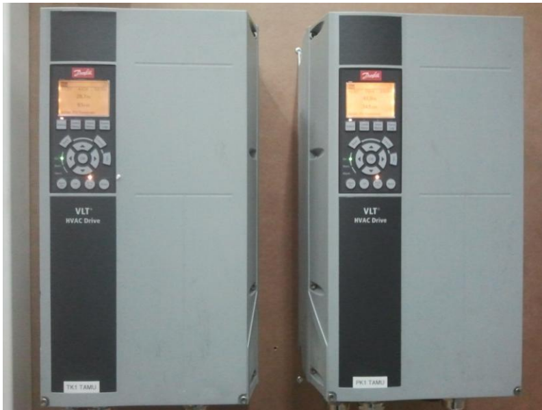
KUVA 12. Taajuusmuuttajat asennettuna Raskoneella (13)
