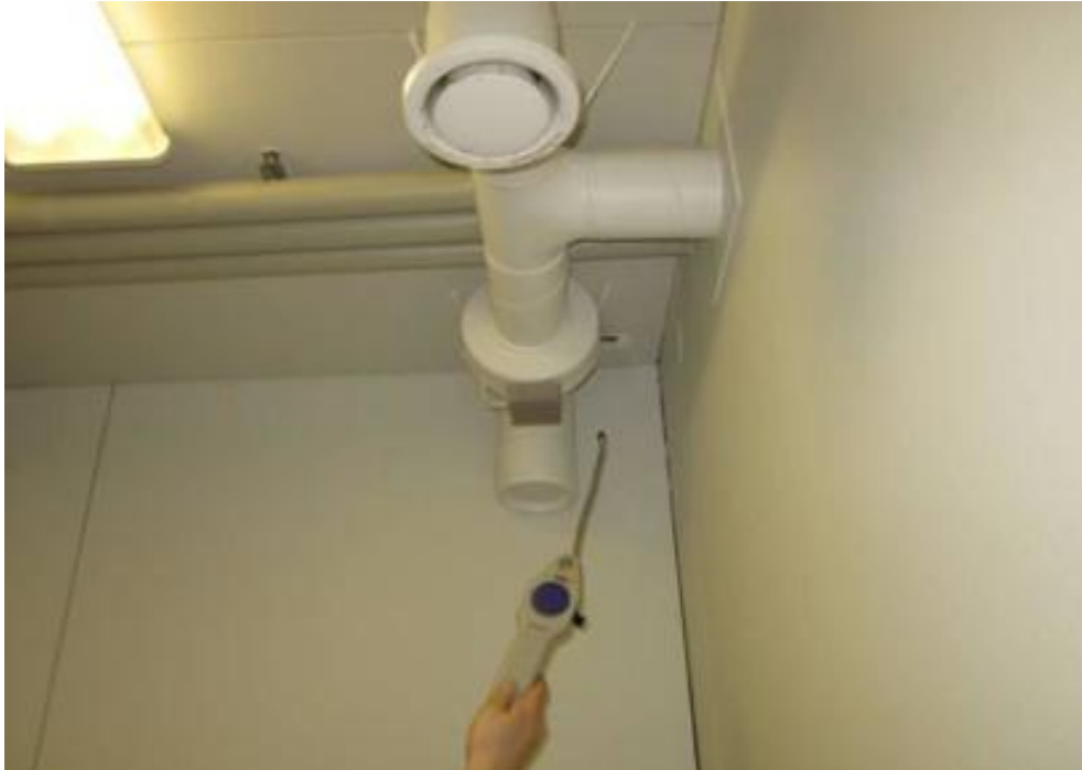
Kuva 12. Merkkiaineen havaitseminen kaasuanalysaattorilla. Kuntotutkimusraportti, kohde A, 2012.
