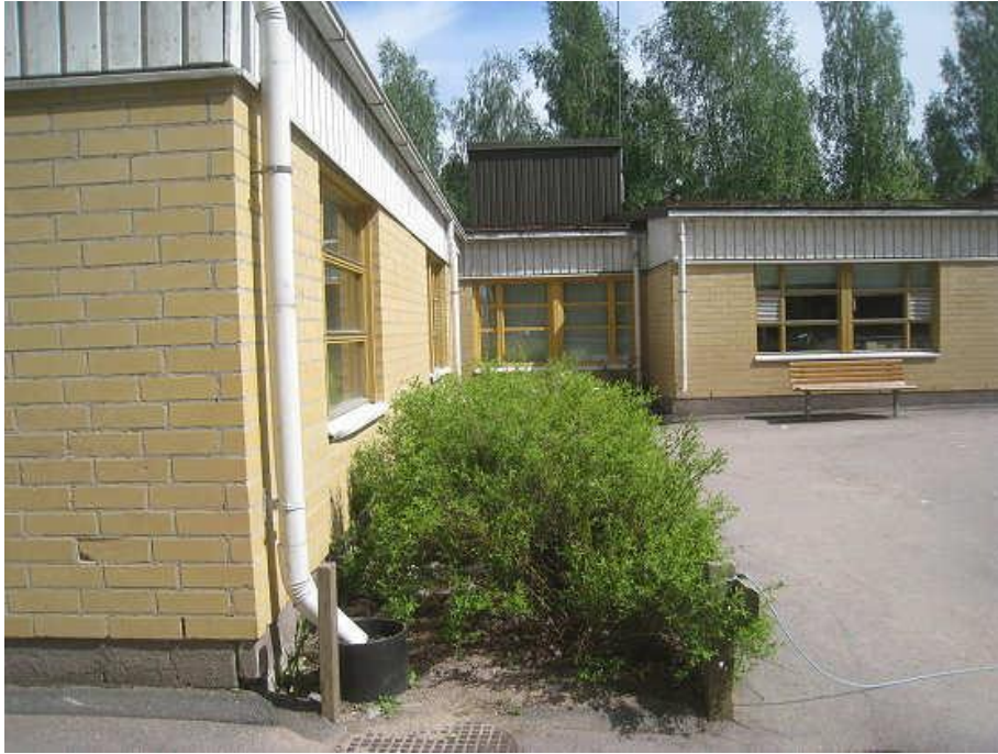
KUVA 17. Kohde B. Kosteusvauriokartoitus-raportti, 2010.
