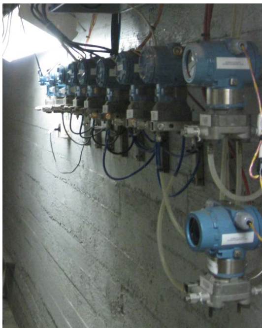
Kuva 17. Rosemount paine-erolähettimeiden asennus Pansion tutkimuslaitoksella.
