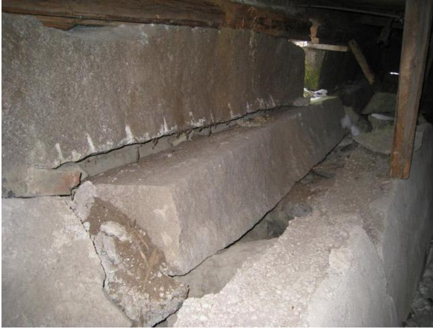
Kuva 24. Lähes kolmemetriset sokkelikivet ovat päässeet siirtymään paikoiltaan.
