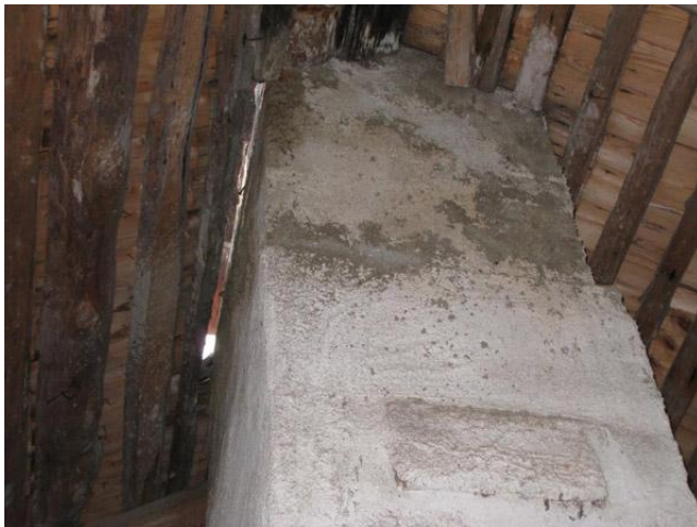
Kuva 13. Piipunjuuri ei ole tiivis.
