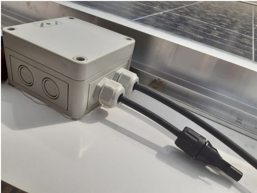
Kuva 9. Aurinkopaneelien kattoläpivienti kotelolla ja holkkitiivisteillä. Kuvassa näkyy oikealla myös MC4 naarasliitin (Kuva: Tuomas Hirvonen).
