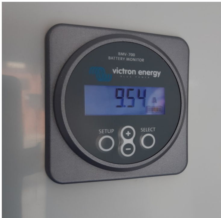
Kuva 30. Akkumonitorin näyttö. Aurinkopaneelilta tulevaa sähkö menee akustolle 9,54 A virralla (Kuva: Tuomas Hirvonen).
