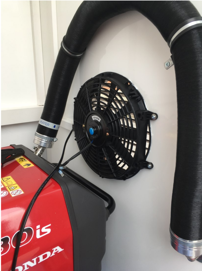
Kuva 22. Aggregaatista tuleva kuuma ilma poistetaan tilasta ajoneuvokäyttöön tarkoitetulla puhaltimella ulos. (Kuva: Tuomas Hirvonen).
