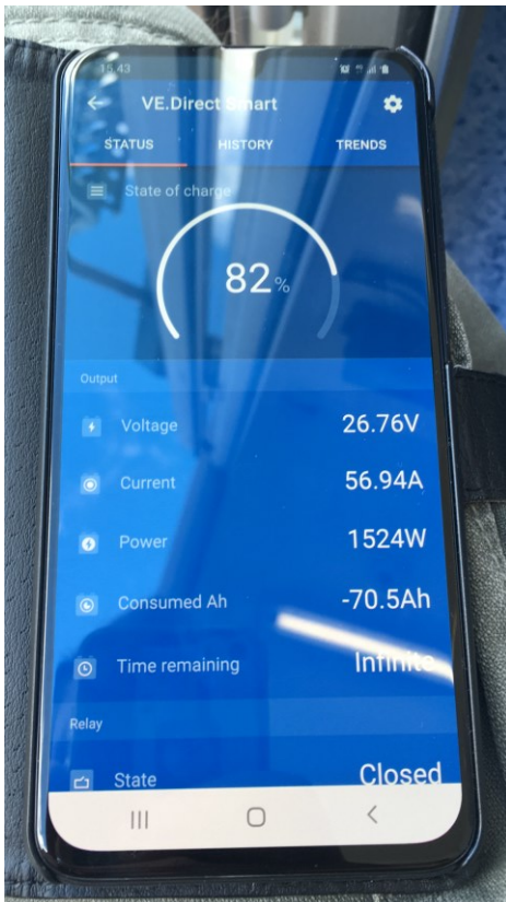
Kuva 17. Akkumonitorin applikaatio, kuvaus hetkellä akustoa ladataan noin 57 A:n virralla. Akun varaustaso näkyy ylimpänä (Kuva: Tuomas Hirvonen).
