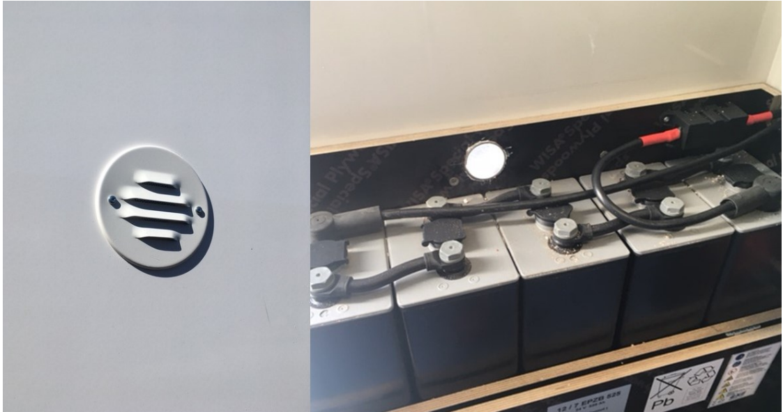
Kuva 15. Akkukoteloiden tuuletus vas. ulkoa ja oik. sisältä. Akuston tunnistus merkinnät erottuvat alareunassa (Kuva: Tuomas Hirvonen).
