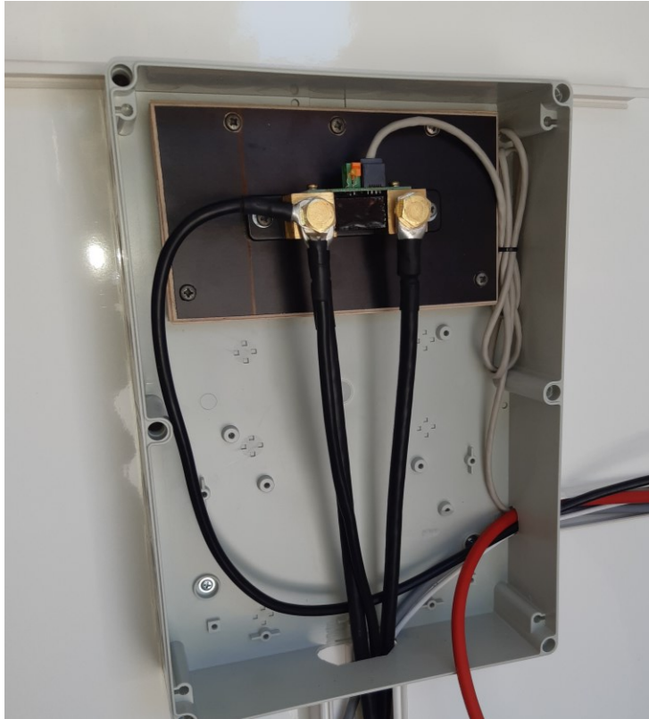
Kuva 16. Akkumonitorin mittausanturi asennettuna erilliseen koteloon (Kuva: Tuomas Hirvonen).
