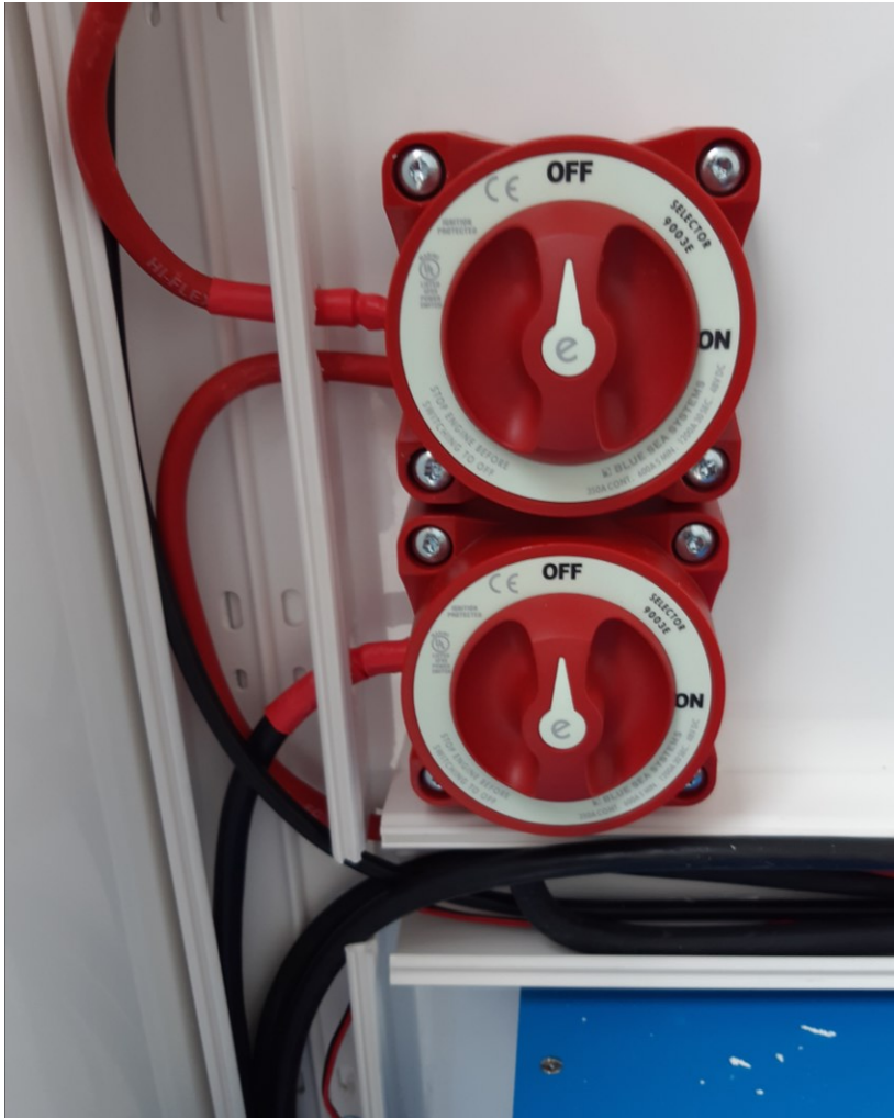
Kuva 27. Aurinkosähköjärjestelmän ja invertteri-laturin päävirtakatkaisimet (Kuva: Tuomas Hirvonen).
