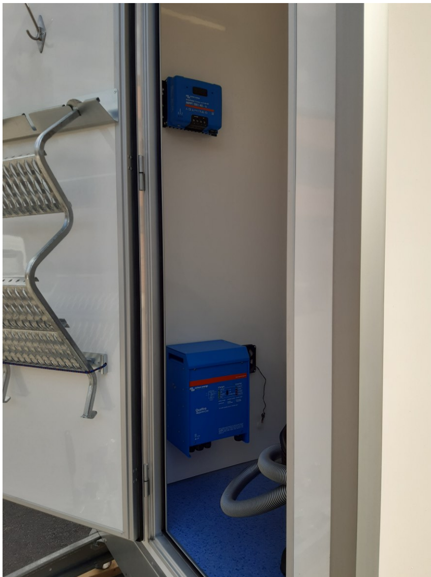
Kuva 7. Aurinkopaneelijärjestelmän MPPT-lataussäädin kiinnitettynä vaunun sisäseinään (Kuva: Tuomas Hirvonen).
