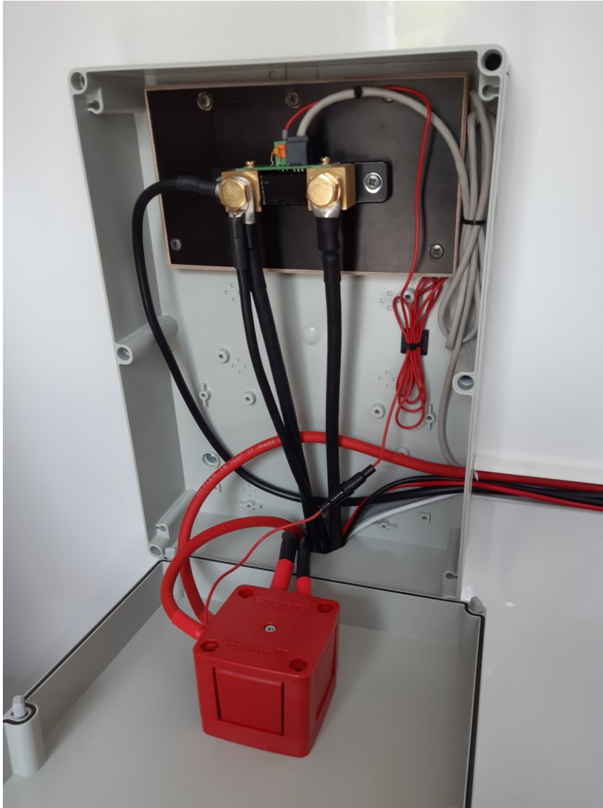
Kuva 26. Akkumonitorin shuntti ylempänä ja akuston päävirtakatkaisin (punainen rasia) (Kuva: Tuomas Hirvonen).
