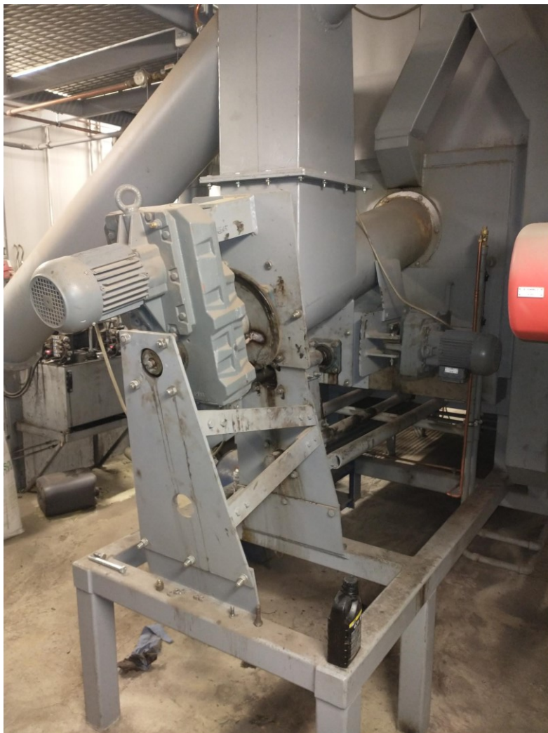
Figur 4: Inne i pannrummet.
