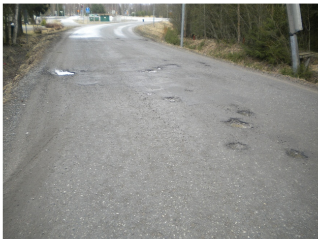
Kuva 13. Huonolaatuinen päällyste, päällysteessä kuoppia
