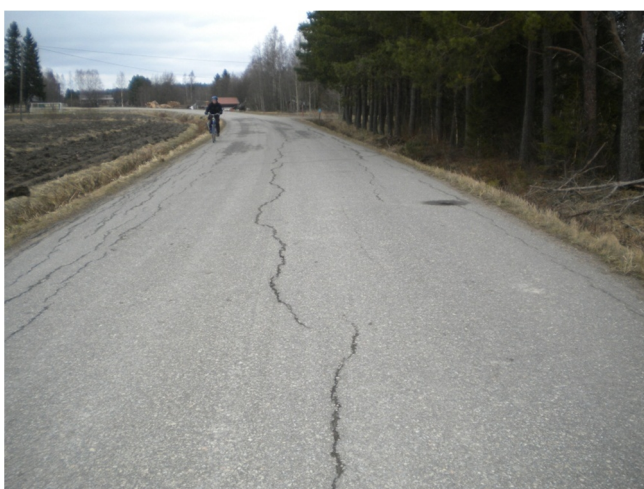
Kuva 14. Melko hyvälaatuinen päällyste, halkeamia muodostunut
