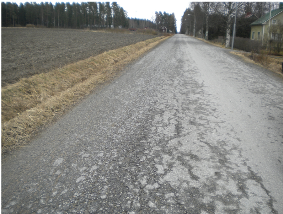
Kuva 2. Erittäin huonokuntoinen tie
