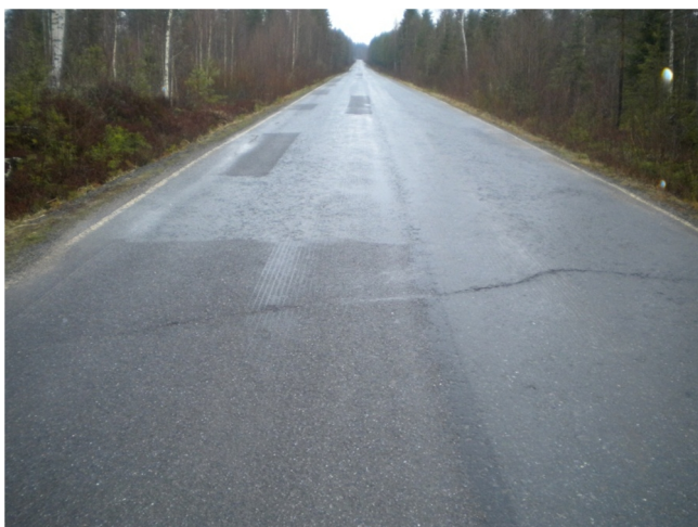
Kuva 15. Melko hyvälaatuinen päällyste, vaurioita paikattu
