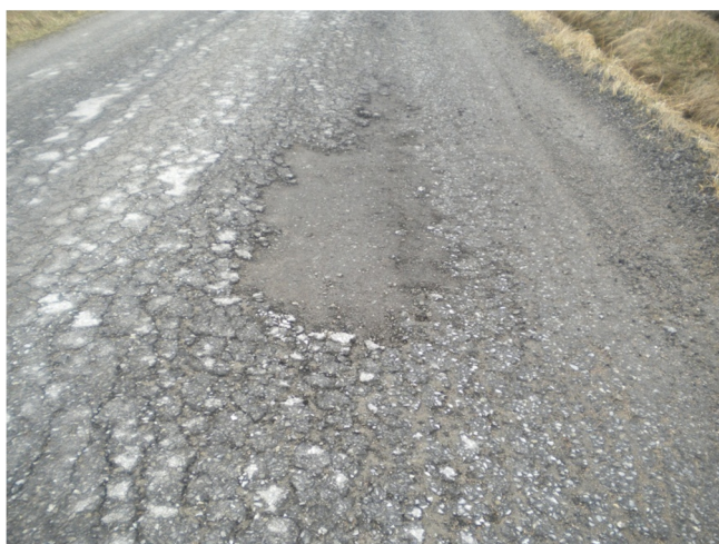
Kuva 12. huonolaatuinen päällyste, verkottumista ja murtumia
