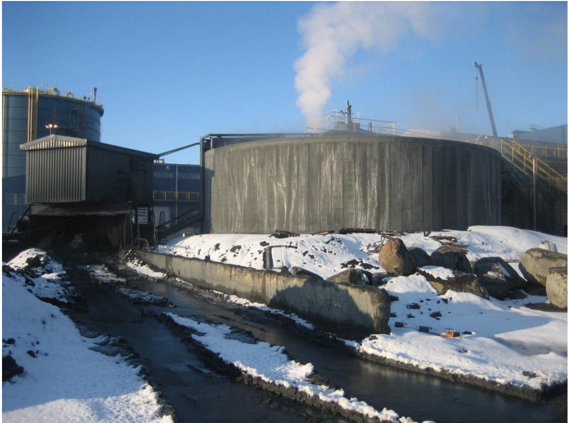
Kuva 4. Haraselkeytinallas ja koppi, jossa dekanterilinko sijaitsee.
