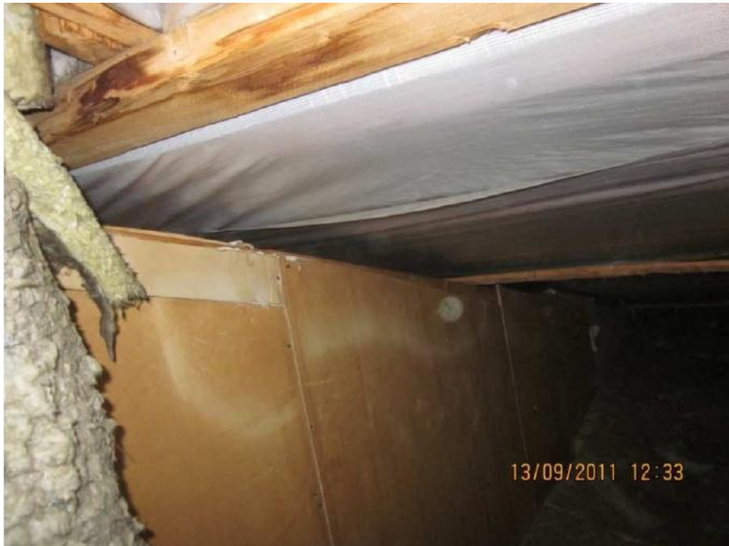
KUVA 13. Palokatkoseinät eivät ulotu vesikatteeseen asti (20, s. 14)
