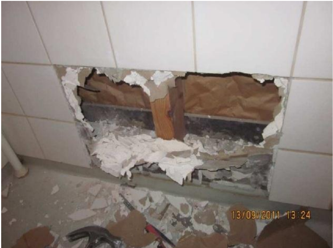
KUVA 11. Pesuhuoneen ja saunan väliseinässä ei ole ollenkaan lämmöneristeitä (20, s. 12)
