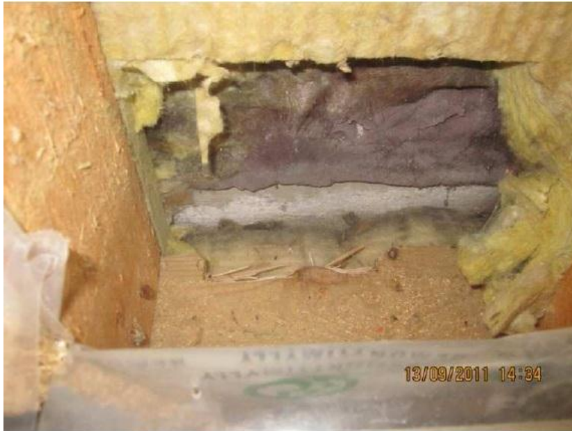
KUVA 8. Ulkoseinän tuuletusrako on tukkeutunut laastipurseista (20, s. 6)
