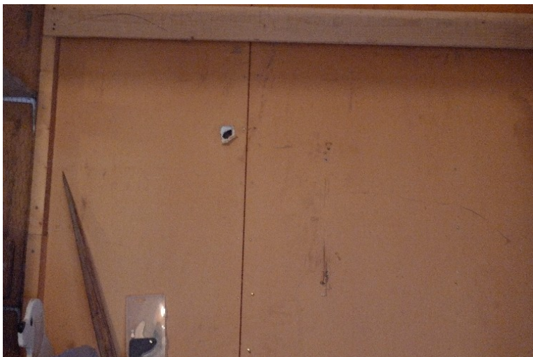
Kuva 26: Varastojen seinissä on kolhuja (3.2.1)
