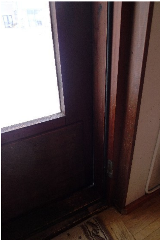
Kuva 18: Terassin ovi on kiero ja suljetun oven raosta näkyy ulos (3.1.2)
