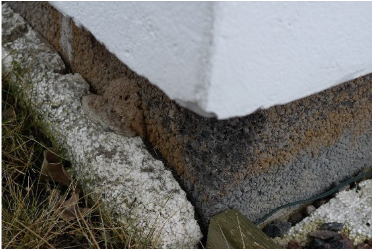
Kuva 5: Sokkelin maalipinta on puutteellinen (3.1.2)
