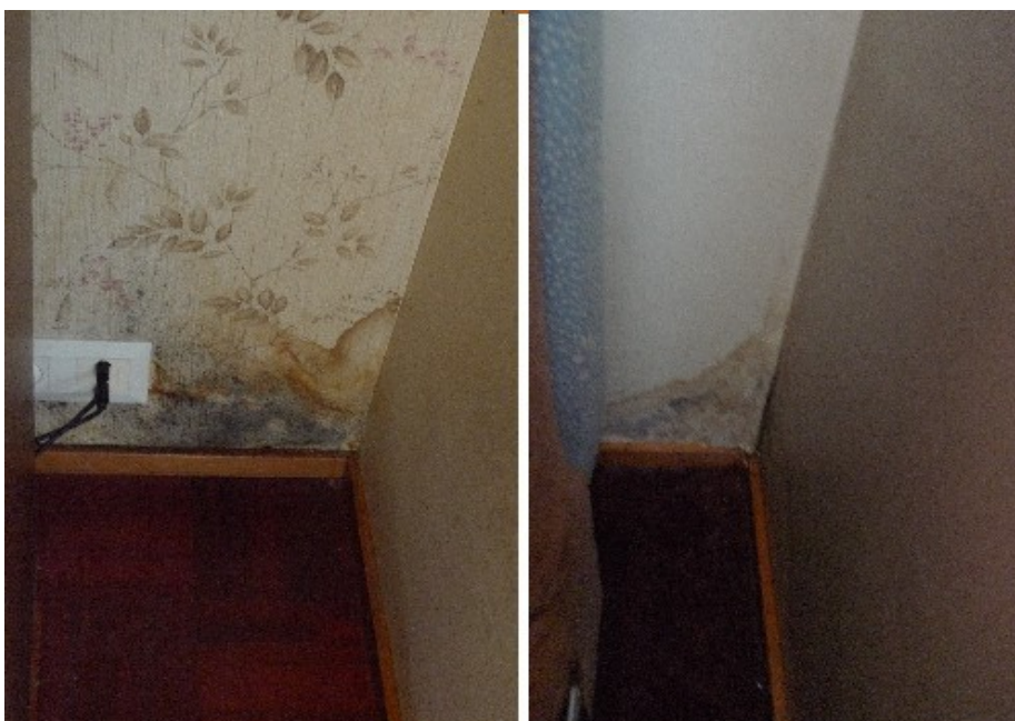
Kuva 29: Asunnon E 17 seinien kosteusvauriot (3.2.2)
