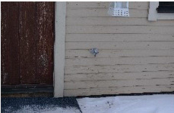
Kuva 8: Julkisivulaudoitus kaipaa huoltomaalausta
