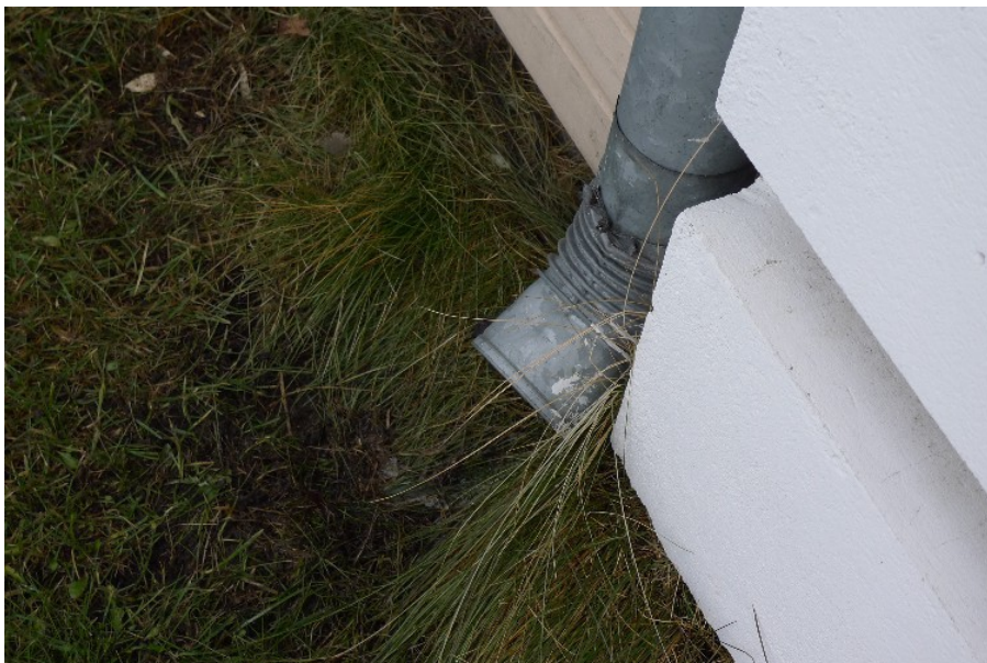
Kuva 30: Asunnon E 17 olohuoneen nurkka ulkoa, missä lyhyt syöksy johtaa veden suoraan nurkalle, josta se ei ohjaudu pois (3.2.2)
