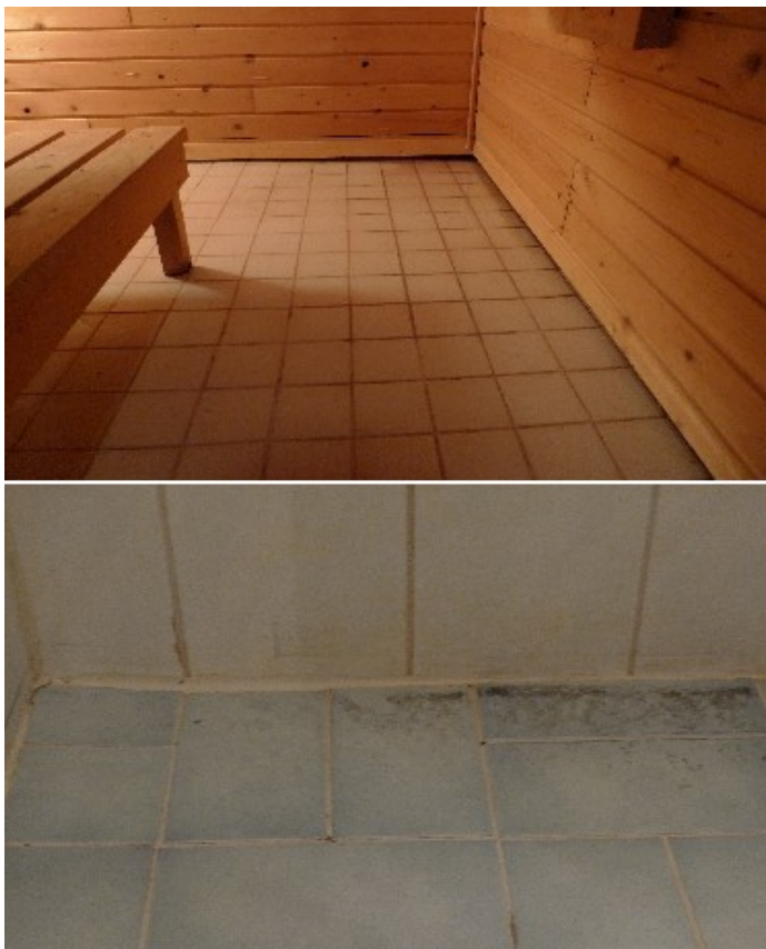
Kuva 28: Lattioiden kallistusten puutteet ohjaavat veden väärin paikkoihin (3.2.2)
