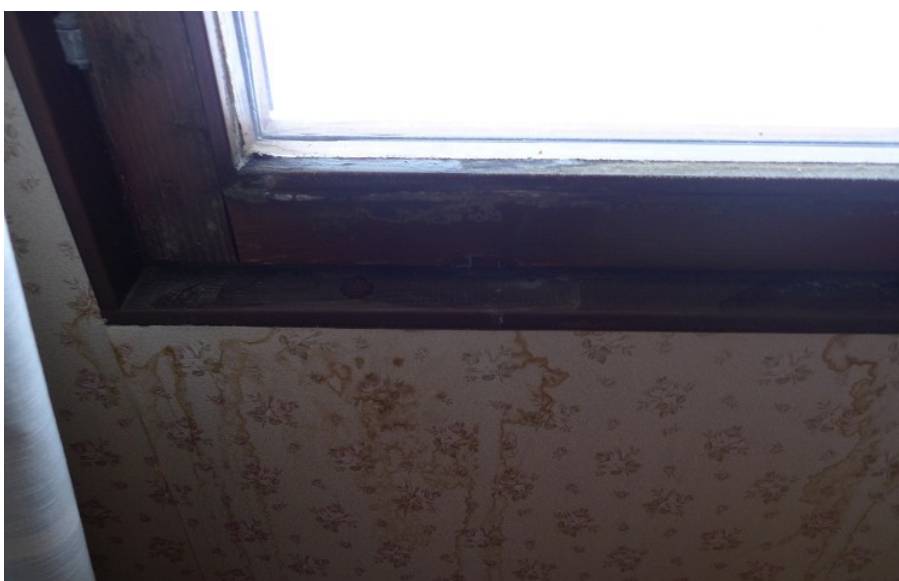
Kuva 31: Kosteus on tiivistynyt ikkunalle (pimennysverhon taakse) ja valunut seinää pitkin (3.3)
