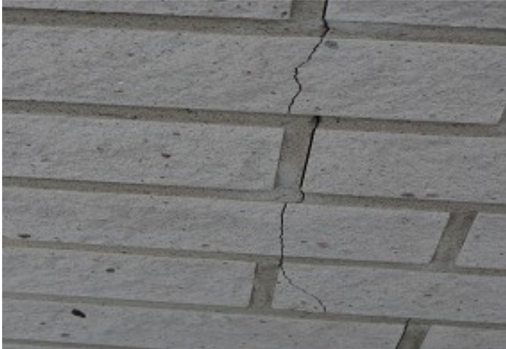
Kuva 4: Halkeama päätyseinän tiilimuurauksessa (3.1.2)
