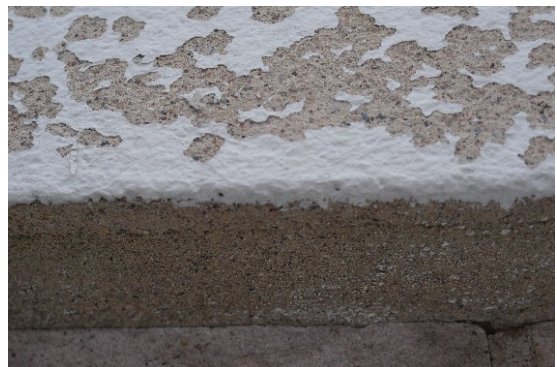
Kuva 10: Koristeulokkeen maalipinta hilseilee (3.1.2)
