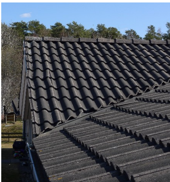
Kuva 25: Tiilet ovat liikkuneet paikoiltaan (3.1.2)
