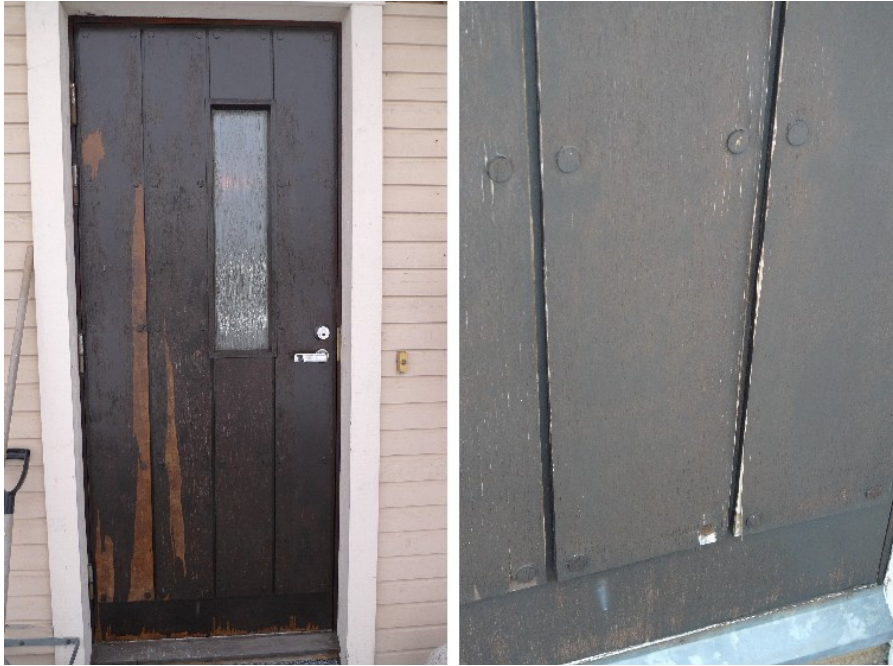
Kuva 17: Ulko-ovien pintaviilu irtoilee (3.1.2)
