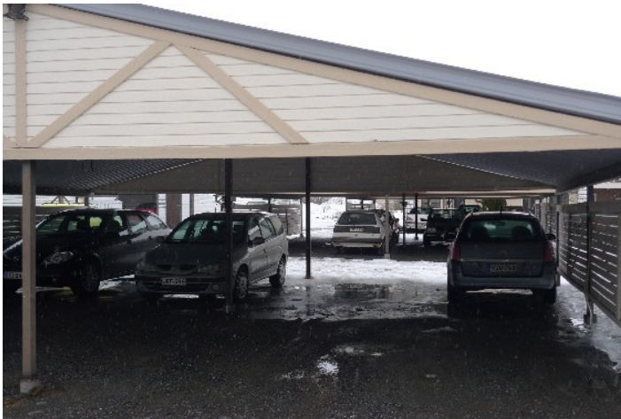
Kuva 2: Vesi lammikoituu autokatokseen (3.1.1)
