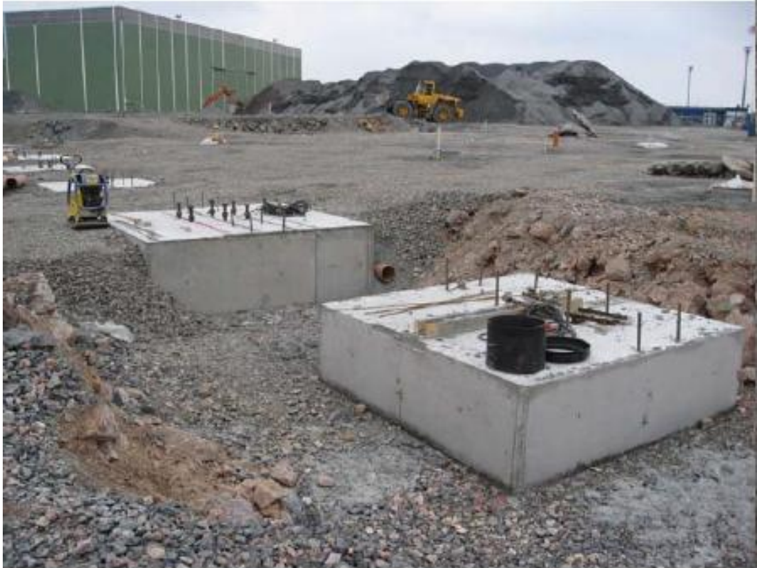
KUVA 6. Rakennustyömaan pohja- ja perustusurakassa kaikki paitsi elementtien pulttien paikat voidaan mitata koneautomaation avulla (Heikkilä, 2009.)
