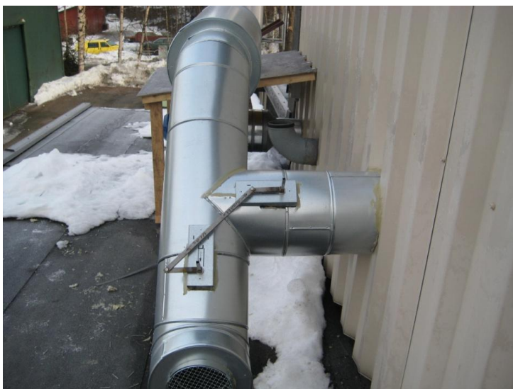
Kuva 9. Imupuhaltimen eristetty putkisto ja säätöpelti.
