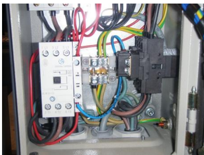
Kuva 14. Moottorinrele ja liitokset.
