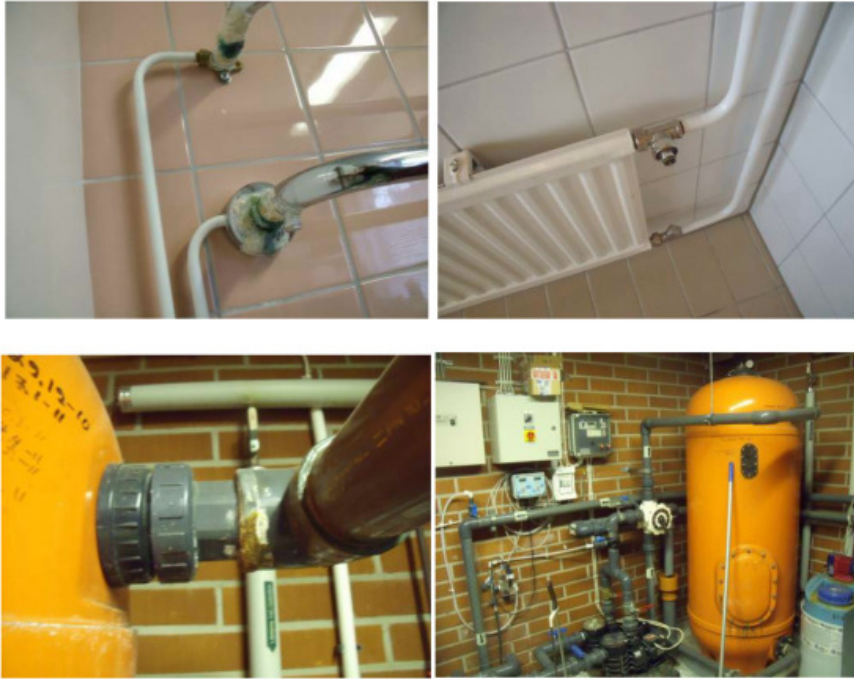
Kuva 17. Havainnointi kuvia osasta päiväkodin LVI-tekniikan yhteenvedon korjaustarpeista.
