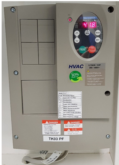
Kuva 9. TK03, poistoilmapuhaltimen taajuusmuuttaja
