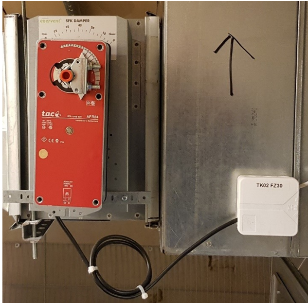
Kuva 8. TK02, poistoilmapellin peltimoottori
