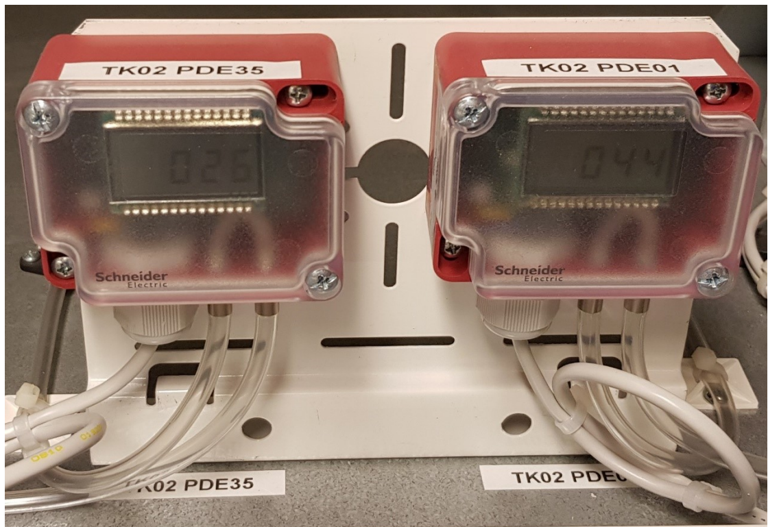
Kuva 6. TK02, Lämmöntalteenoton ja ulkoilmasuodattimen paine-erolähettimet
