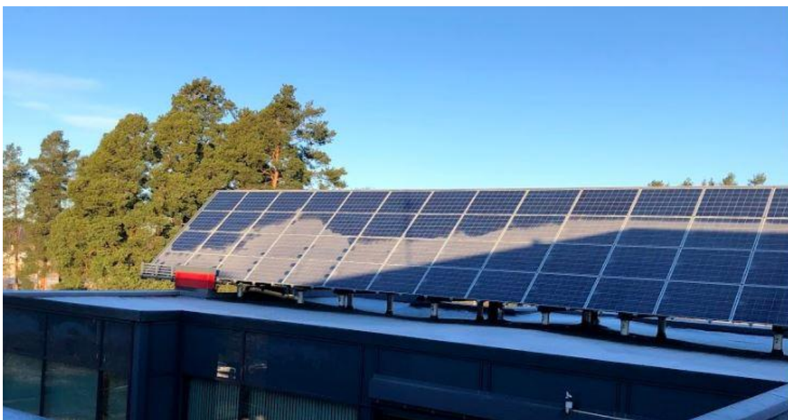
Kuva 9. Osa Vaisala Oyj:n pääkonttorin aurinkopaneelijärjestelmää.
