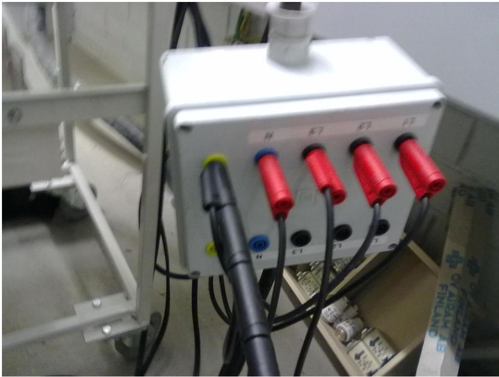
Kuva 3 Jännitetieto otetaan jokaiselta vaiheelta ja nollajohdolta, vertailupisteeksi otettiin suojamaa.
