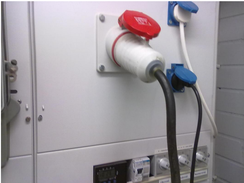
Kuva 4 Jännitemittapäihin yhdistetty pistotulppa on kytketty keskuksessa sijaitsevaan kolmivaihepistorasiaan. Mittalaitteen tehonsyöttö tulee sen vieressä olevasta yksivaiheisesta pistorasiasta.
