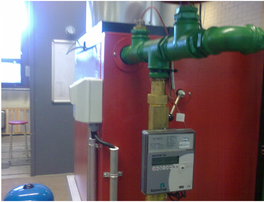
Kuva 9. Biokattilan käyttöpaneelin takana oleva mittauspiiri
