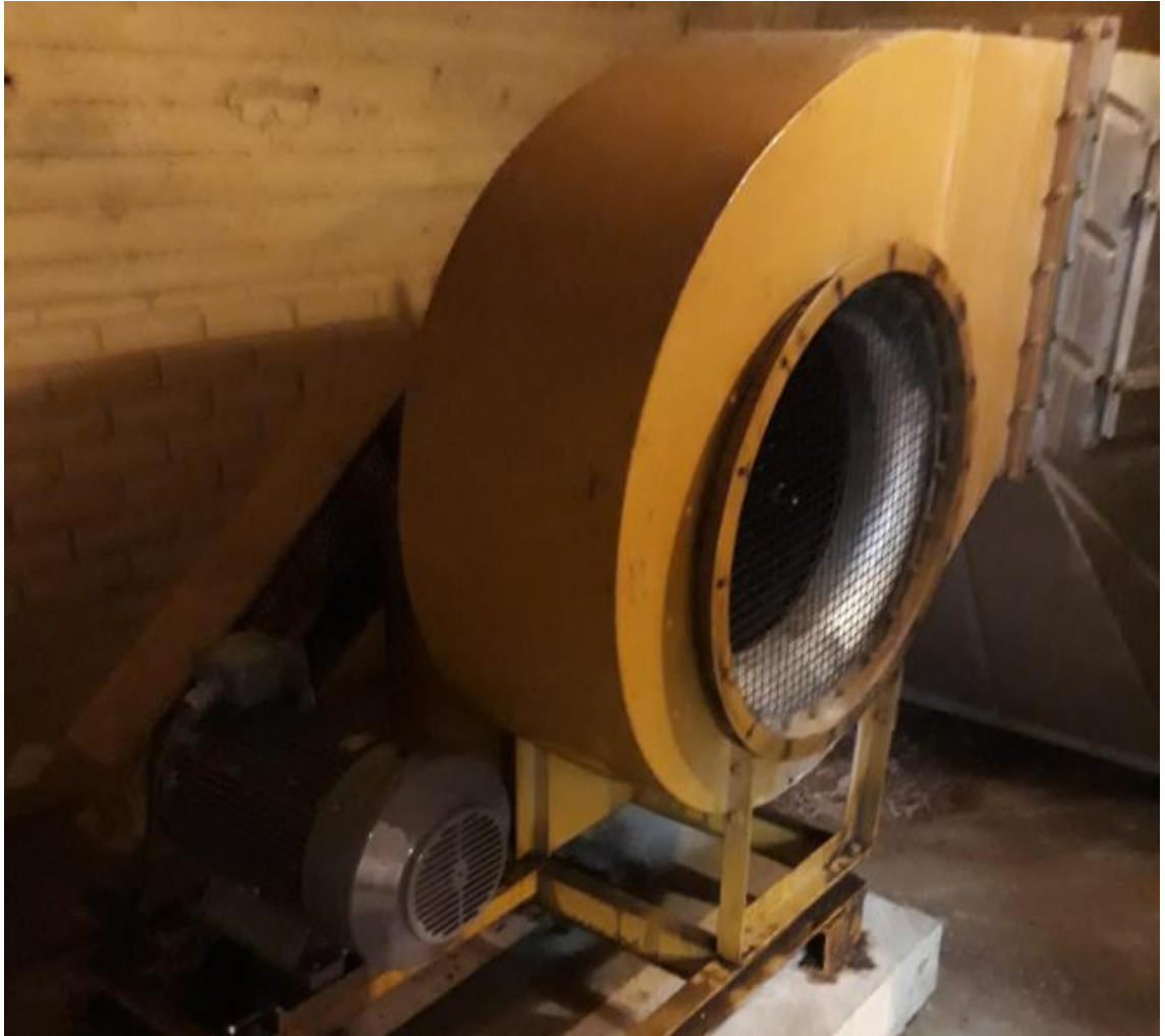
Kuva 2. Hiomon pääkytkinlaitoksen sähkötilan kiertoilmapuhallin 2134 6671
