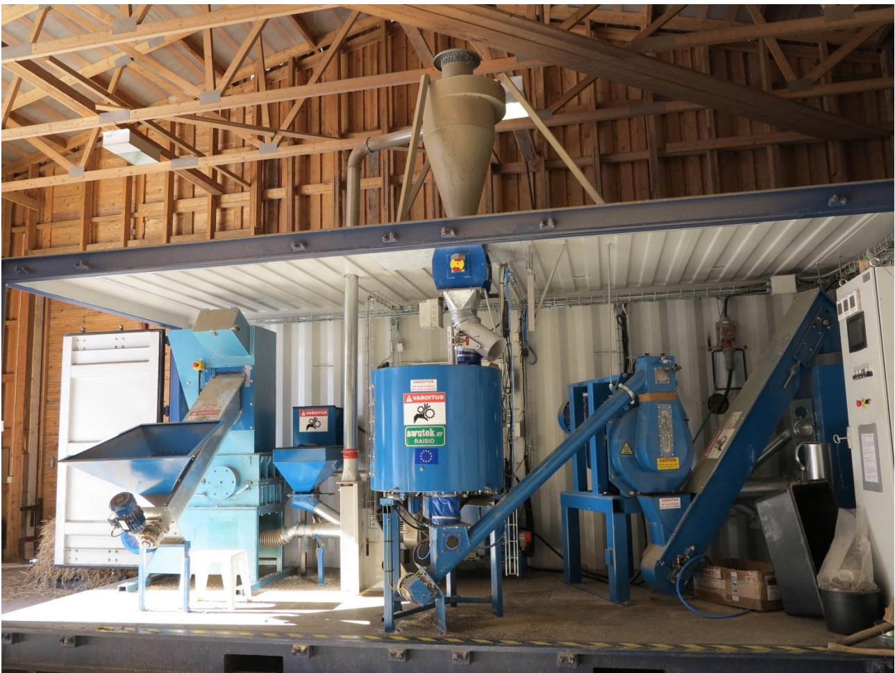
Kuva 1. Liikuteltava pelletöintilaitteisto. Vasemmalta lähtien esimurskain, vasaramylly, yllä lisäsyöteyksikkö, välisäiliö, puristinyksikkö, jäähdytystorni ja hallinta-automaattikka. Kuva: Mikko Aalto
