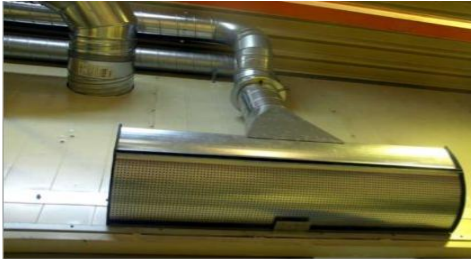
Hymy-tuloilmalaite asennetaan 2-3 metrin korkeudelle, josta ilmaa puhalletaan kohti lattian rajaa.
