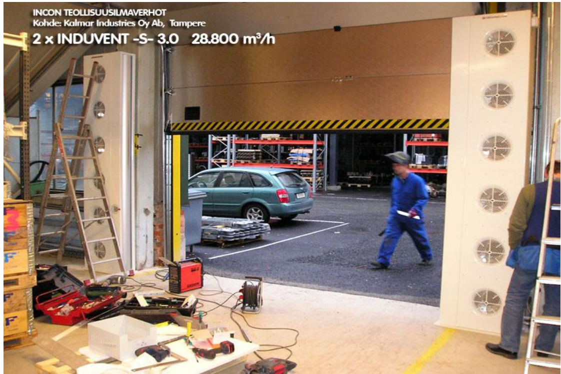
KUVA 11. Induvent-S ilmaverho referenssikohteessa. (A-Incon Oy.)
