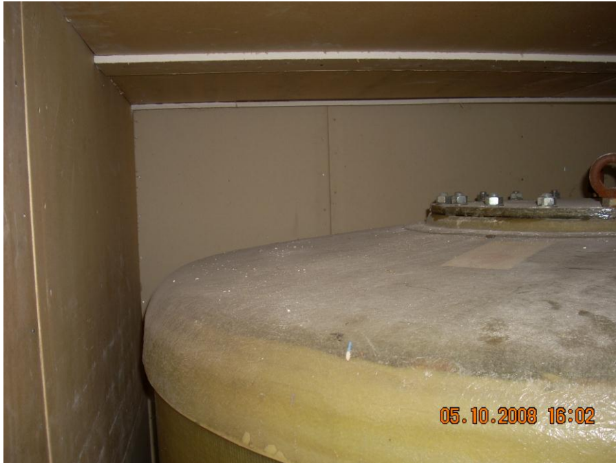
KUVIO 24. Tilassa, jossa öljysäiliö sijaitsee, on seinillä erikoiskova kipsilevy.
