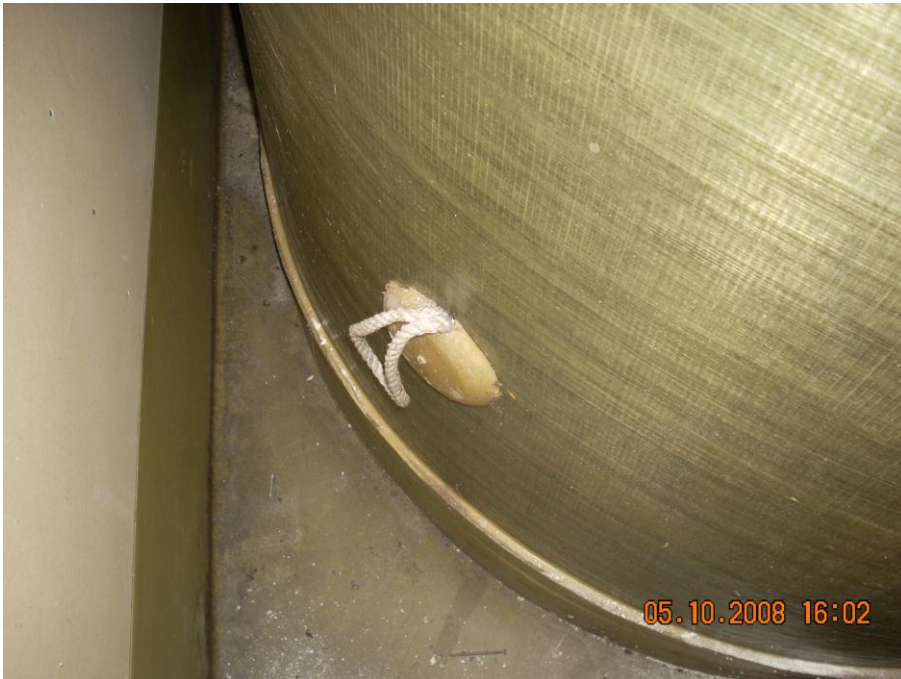
KUVIO 23. Öljysäiliö, jossa alhaalla näkyy korotettu suoja-allas.
