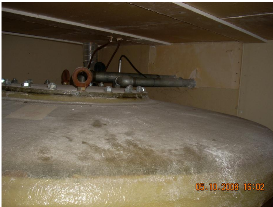
KUVIO 25. Öljysäiliöön ulkoa tulevat täyttöputket.
