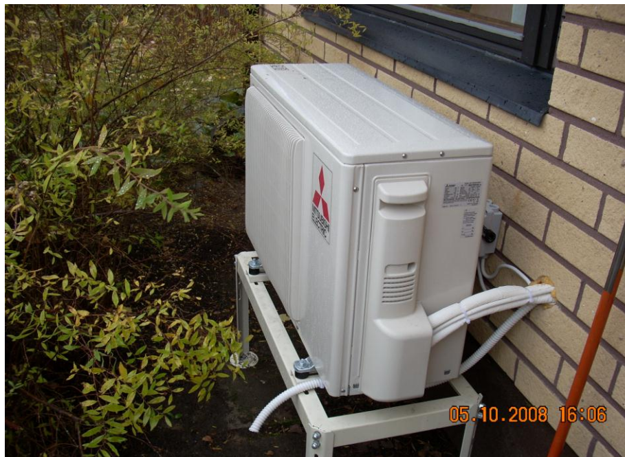
KUVIO 7. Ilmalämpöpumpun ulkoyksikkö.
