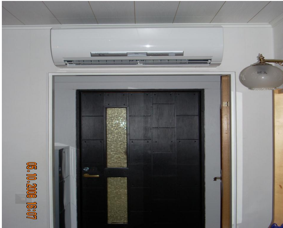
KUVIO 8. Ilmalämpöpumpun sisäyksikkö.
