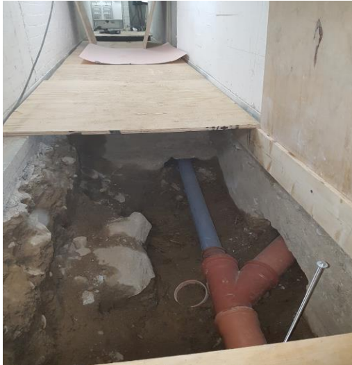
Kuva 3. Pohjaviemäriin on kytketty pystyviemärihaara.
