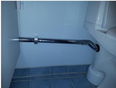
Kuva 6. Pesualtaan poistoputki on yhdistetty WC-istuimeen.
