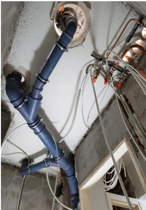
Kuva 2. Ylimmäisen märkätilan viemärit on hajotettu alimmaisen kylpyhuoneen kattoon. Asennus vaatii läpimenoreikien tekoa.
