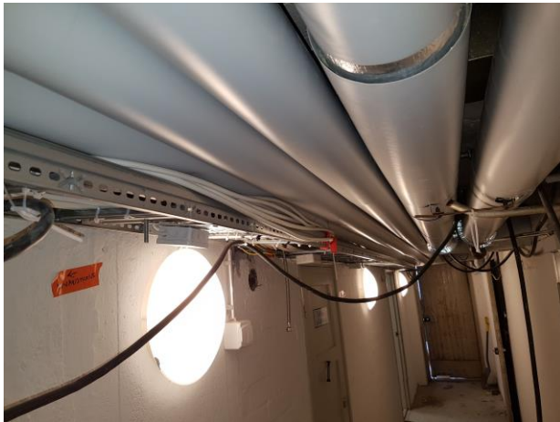
Kuva 17. Kuvassa on tilanne, kun katossa olevalle tekniikalle ei riitä tilaa.
