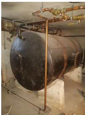
Kuva 10. Vanhanaikainen lämmönsiirrin, mitat 1,5 metriä x 3,5 metriä.
