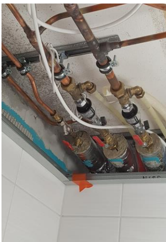
Kuva 8. Tässä kuvassa on eristetyt käyttövesikupariputket; lämmin, kylmä ja kiertovesi.
