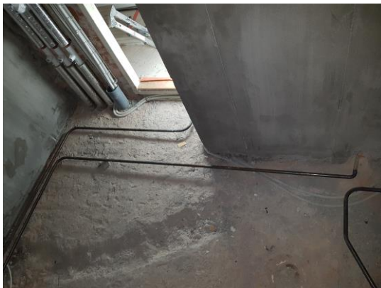
Kuva 12. Kylpyhuoneen lattiassa kuvatut lämmitysputket
