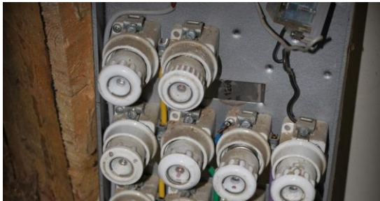
Kuva 13. Vanhanaikainen ryhmäkeskus Gg- tai tulppasulakkeella varustettuna.
