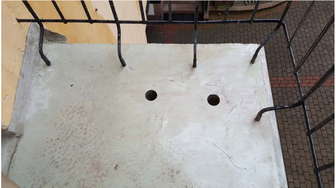
Kuva 28. Alin parveke. Betonilieriöiden porauspaikat.
