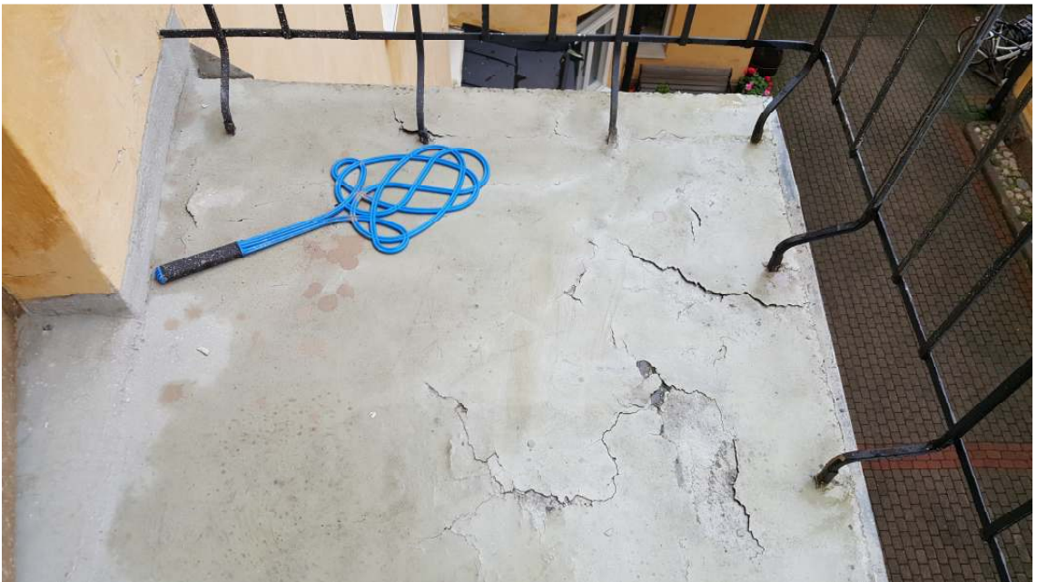
Kuva 27. Alin parveke. Pinnoite on vaurioitunut.
