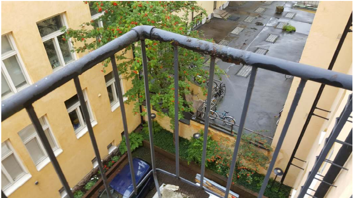
Kuva 25. Ylin parveke. Kaiteessa on runsaasti korroosiovaurioita, paikoin ruostunut puhki.
