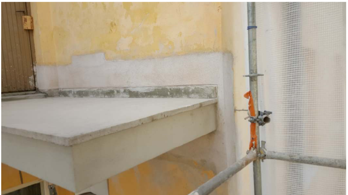
Kuva 39. Parvekelaatat on valettu ja muotit poistettu. Liittyvien seinäpintojen paikkaus- ja paikkarappaus-työt on tehty. Parvekelaatan ja seinän liittymään tehtiin ns. jalkalista alkuperäisen toteutuksen mukaisesti.
