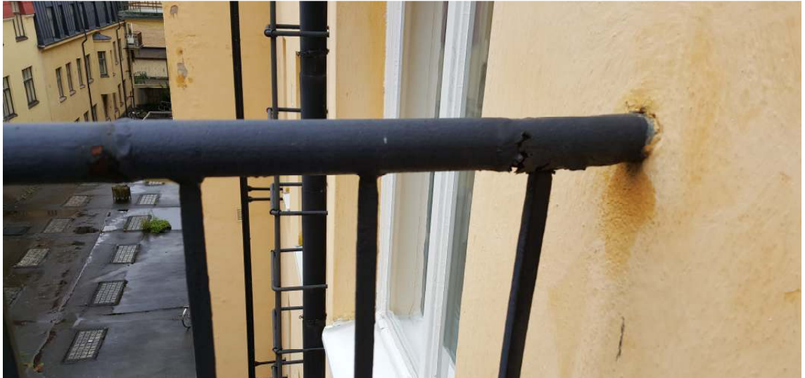
Kuva 24. Ylin parveke. Kaide on ruostunut puhki.
