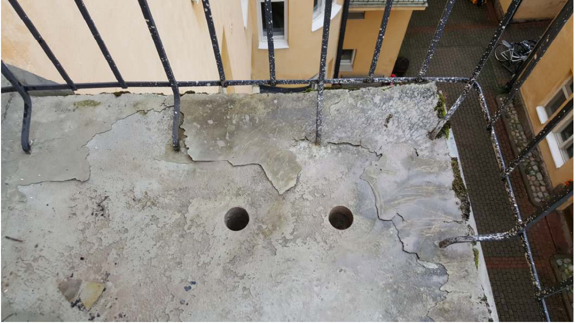
Kuva 26. Ylin parveke. Betonilieriöiden porauspaikat. Pinnoite on vaurioitunut, samoin pintabetonilaatassa on näkyviä vaurioita.
