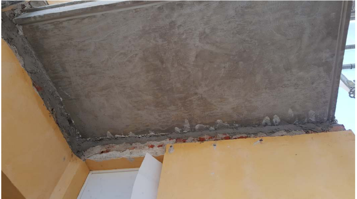
Kuva 38. Parvekelaatat on valettu ja muotit poistettu. Laatan alapinnassa kiertää ns. vesiura etureunoja myöden, näin yläpuolelta valuva vesi ei pääse kastelemaan alapintaa esim. tuulen vaikutuksesta.
