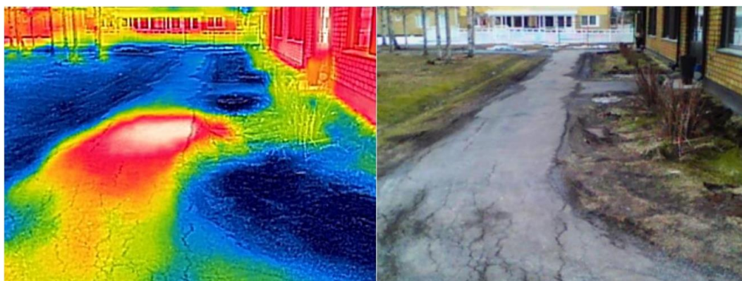
Kuva 3. Lämpökamerakuvassa potentiaalinen vuotokohta näkyy selvästi (Siltala 2017)
