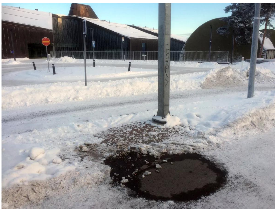
Kuva 2. Mahdollinen kaukolämpövuoto on sulattanut lumet jalkakäytävältä (Tikkamäki 2016)
