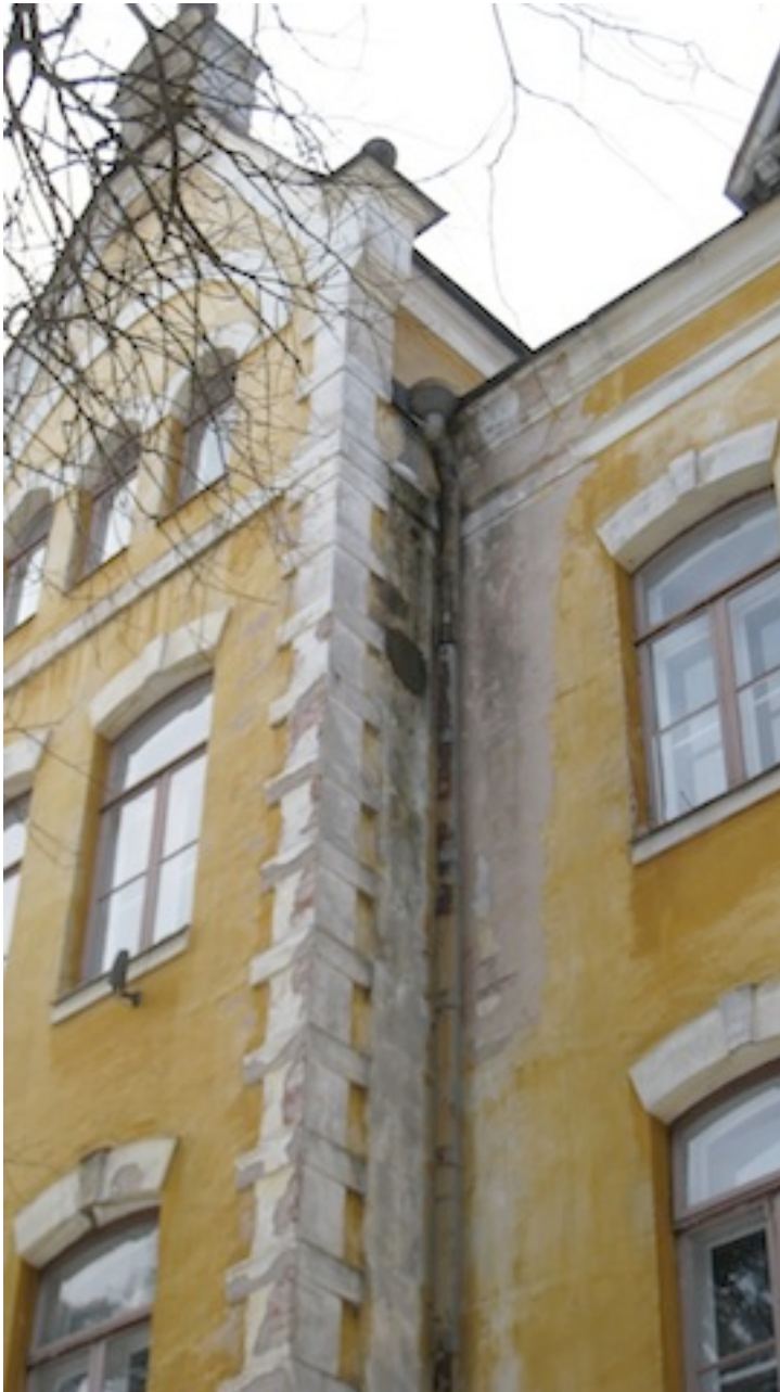
kuva 16. Rikkinäisestä sadevesijärjestelmästä aiheutunutta vahinkoa julkisivussa
