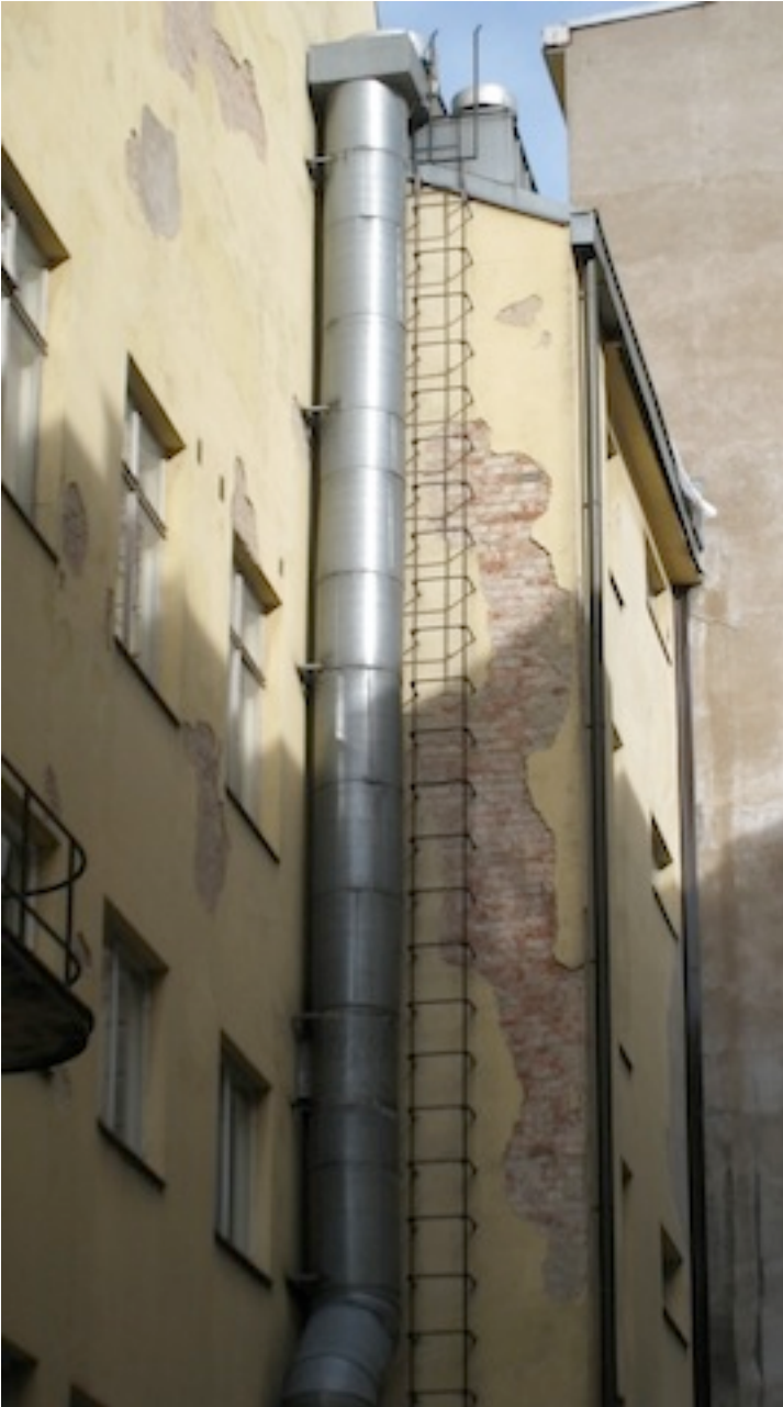
kuva 26. Rapautunutta julkisivua sisäpihalla 2
