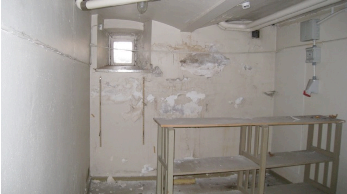
kuva 14. Kosteuden aiheuttamaa tasoitteiden irtoamista kellarikerroksen seinässä
