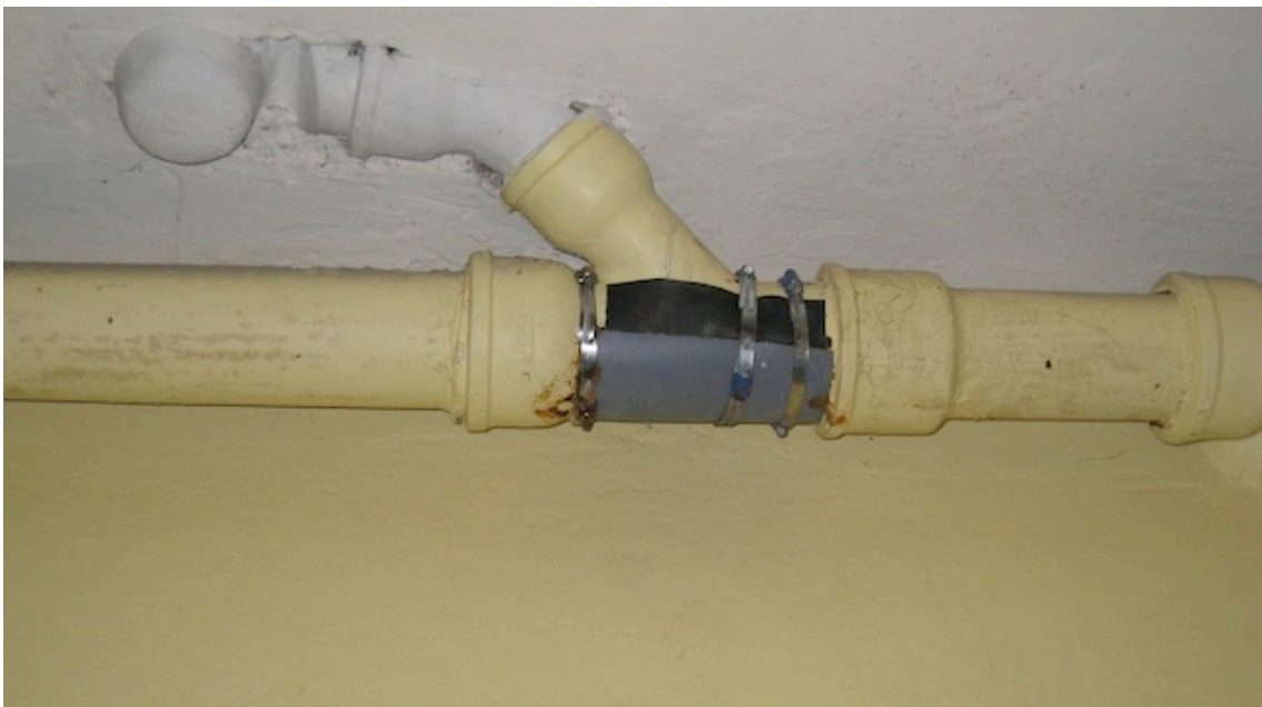
kuva 13. Paikattu viemäri kellarikerroksessa
