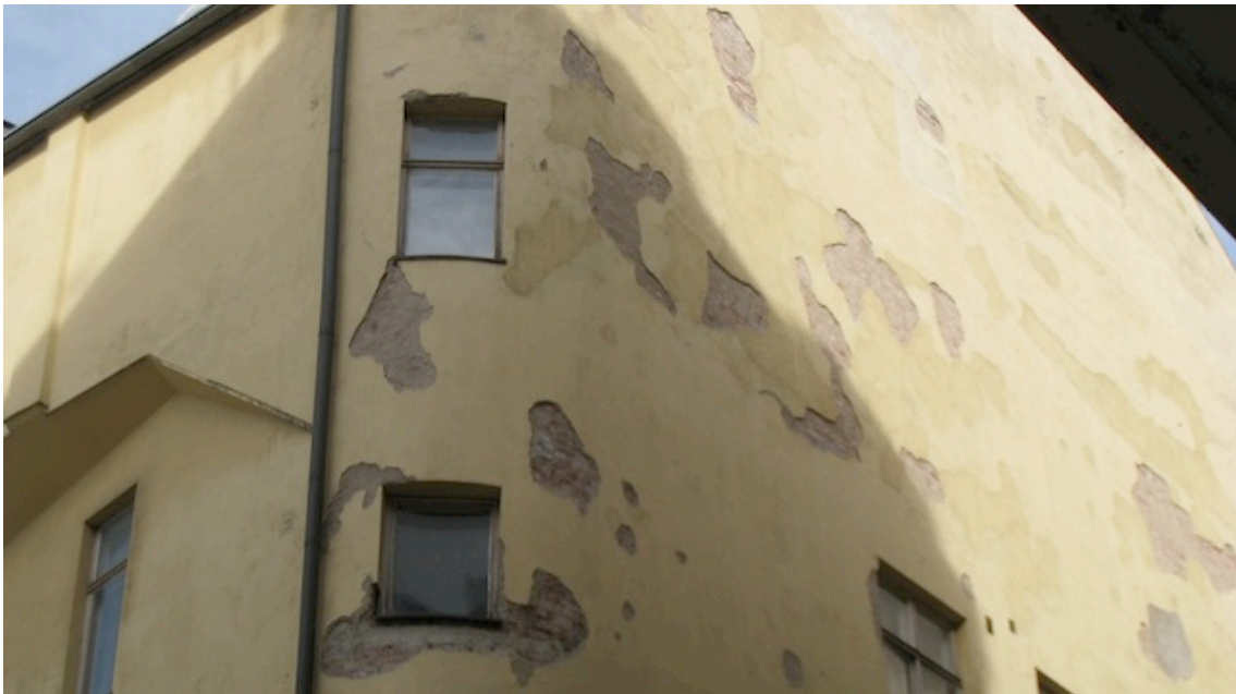
kuva 25. Rapautunutta julkisivua sisäpihalla
