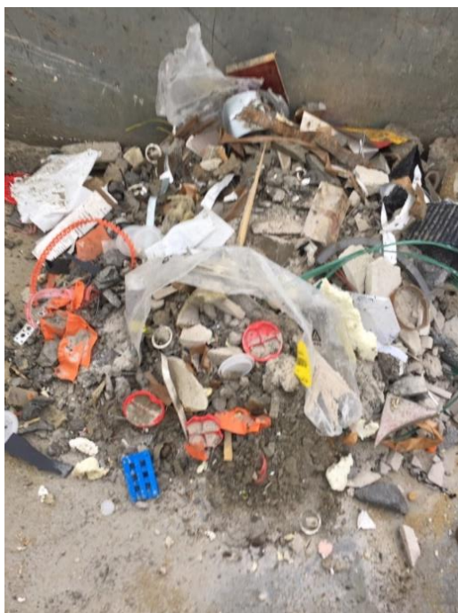
Kuva 1. Sekalaista rakennusjätettä Joensuun Ellin työmaalla (Kuva: Teemu Niemi).
