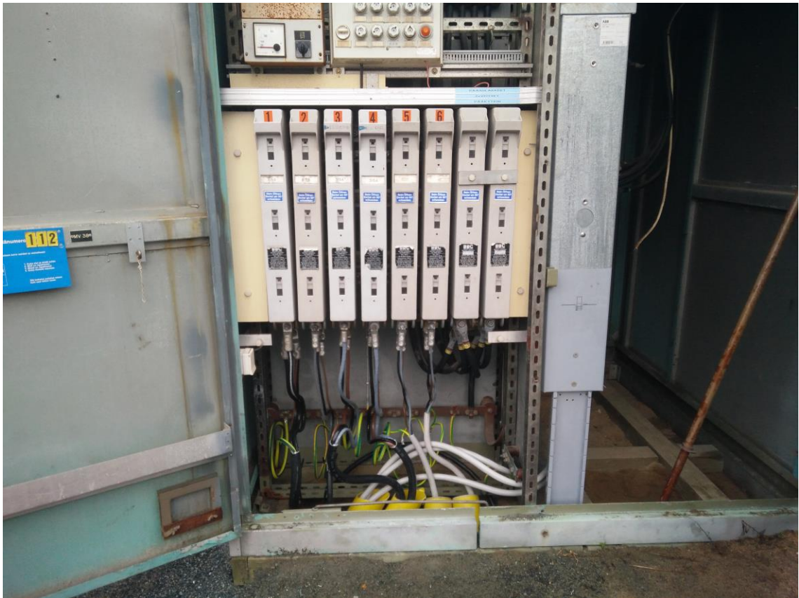
Kuva 7. osa muuntajan M003 kaapelilähdöistä.
