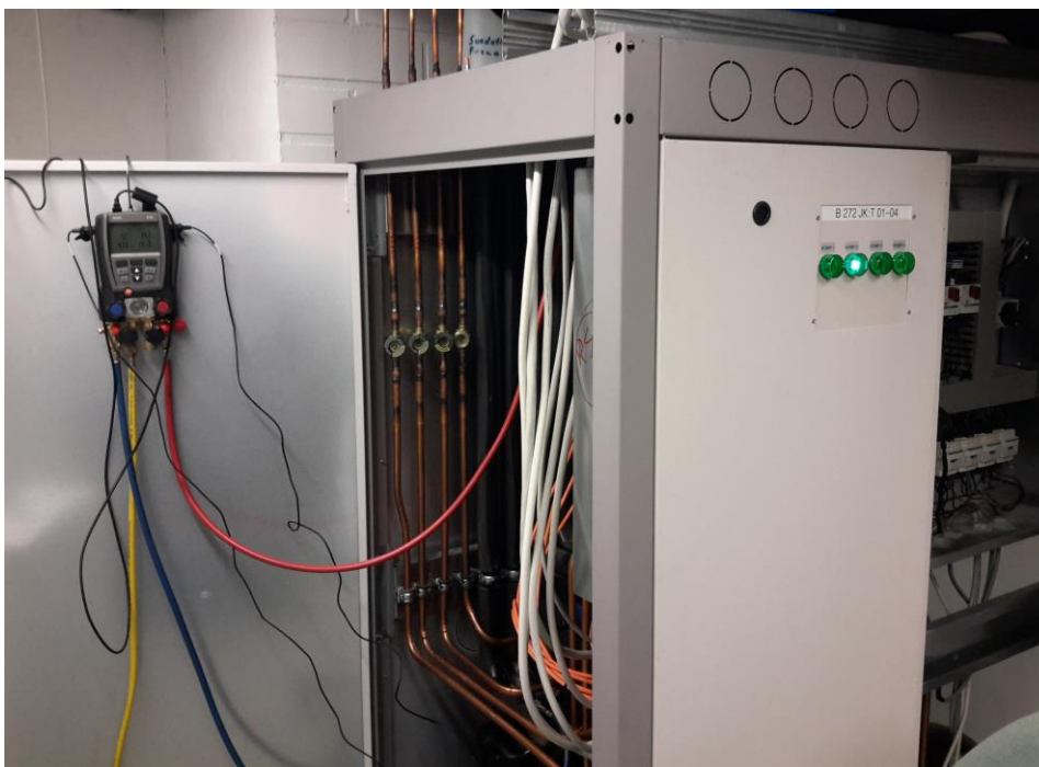
Kuva 13. Chiller-kompressorikoneikko B272 ja digitaalinen asennusmittari Testo 570.
