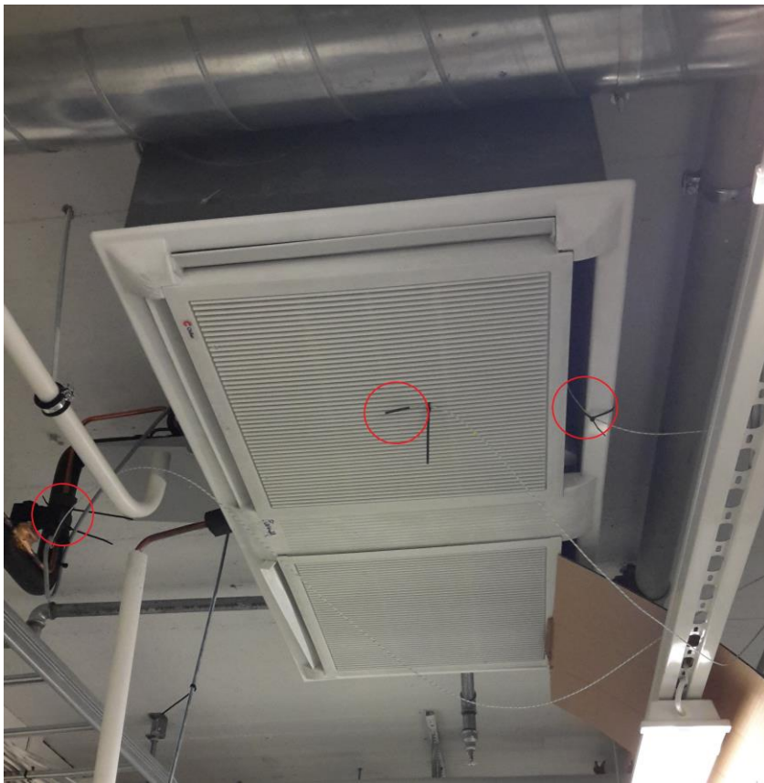
Kuva 9. Chiller KDC 12 C -kattojäähdytyskasetti, lämpötilan mittausturit kuvassa ympyröity.
