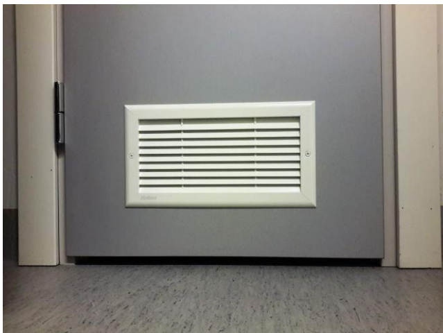
Kuva 17. Tekniikkatilan ovi, oviraot ja siirtoilmasäleikkö Halton TVC 300X150.
