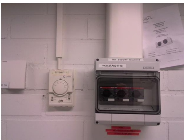
Kuva 15. Lämpötila-anturi, jäähdytysyksikön säädin ja hätäjäähdytyksen ohjauskeskus.
