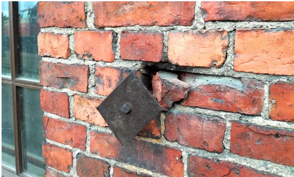
Kuva 35. Tukirakenteen ruostuminen aiheutti tiilen irtoamisen muurista. Kuva: E. Kangas, 06.2017.
