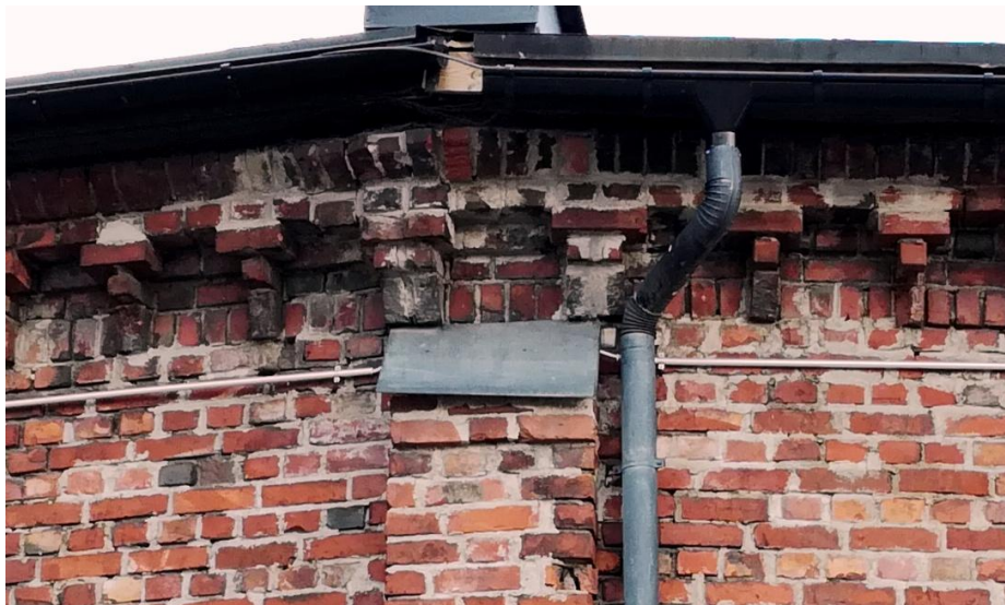
Kuva 34. Pellitysten kiinnitys, tiivistys ja toimivuus tulee tarkastaa. Kuva: E. Kangas, 06.2017.
