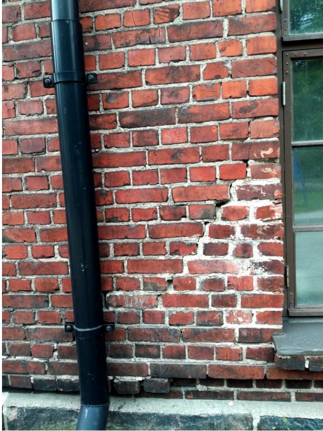
Kuva 29. Rakenteellisesta liikkeestä johtuva halkeama tiilimuurissa. Kuva: E. Kangas, 06.2017.
