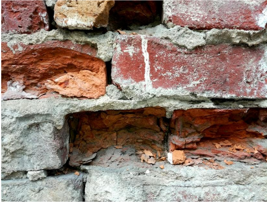
Kuva 8. Pitkälle edenneet pakkasvauriot tiiliseinässä. Kuva: E. Kangas, 06. 2017.
