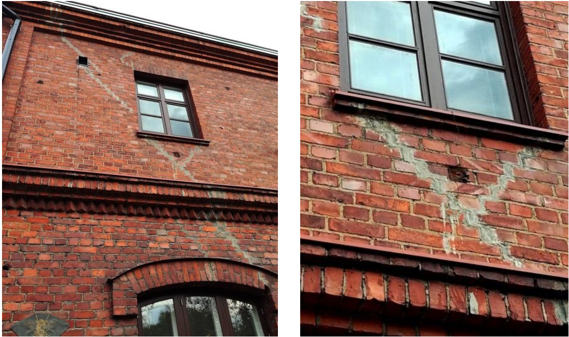
Kuva 14. Riihimäen lennätinkonepajan julkisivussa korjattu halkeama. Kuva: E. Kangas, 06.2017.
