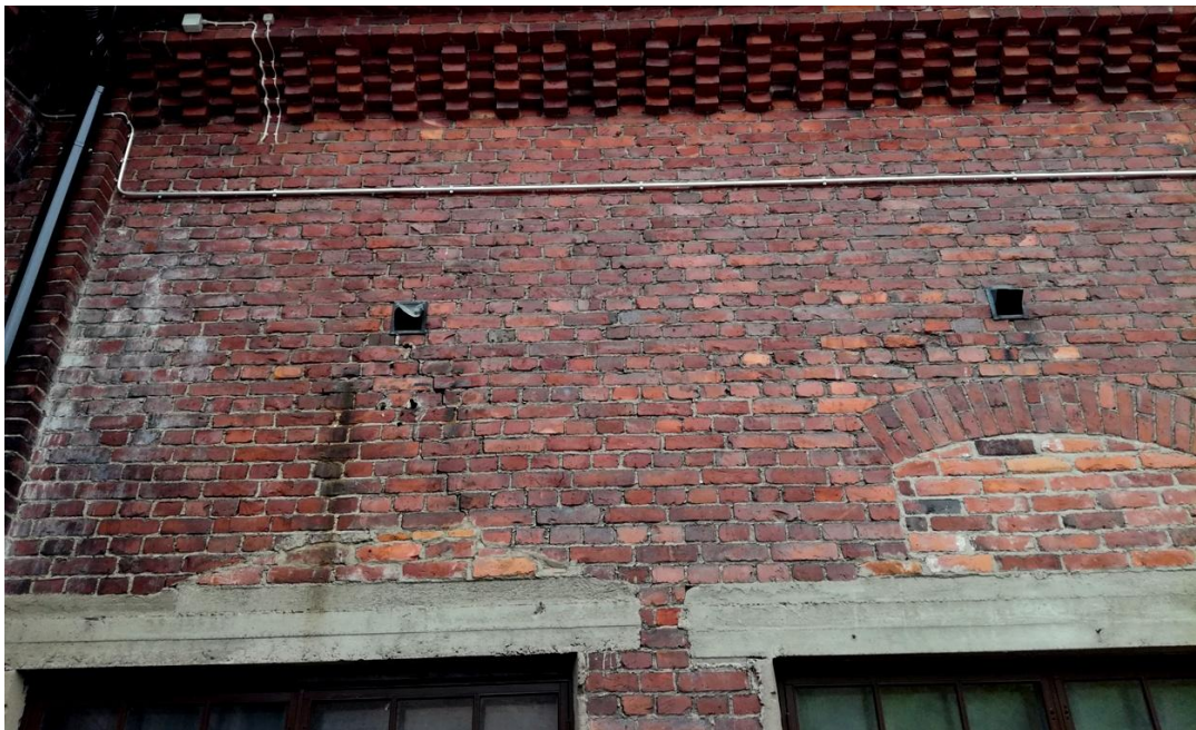
Kuva 30. Ikkunoiden yläpuolelle ilmestynyt halkeilu laastisaumoissa. Kuva: E. Kangas, 06.2017.
