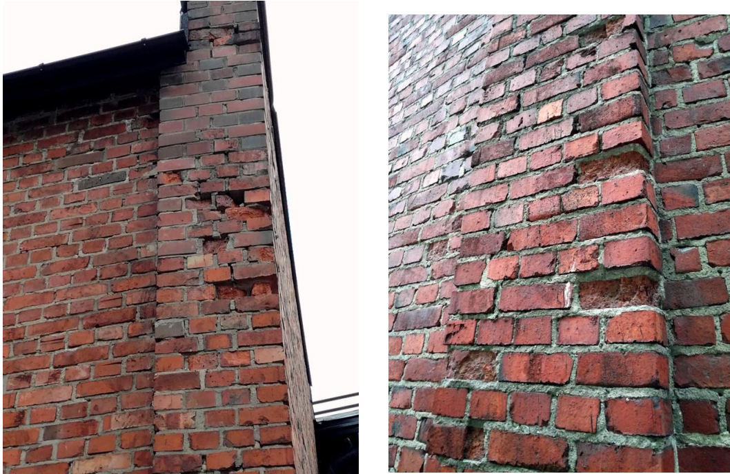
Kuva 31. Vaurioituneet tiilet julkisivujen pilastereissa. Kuva: E. Kangas, 06.2017.
