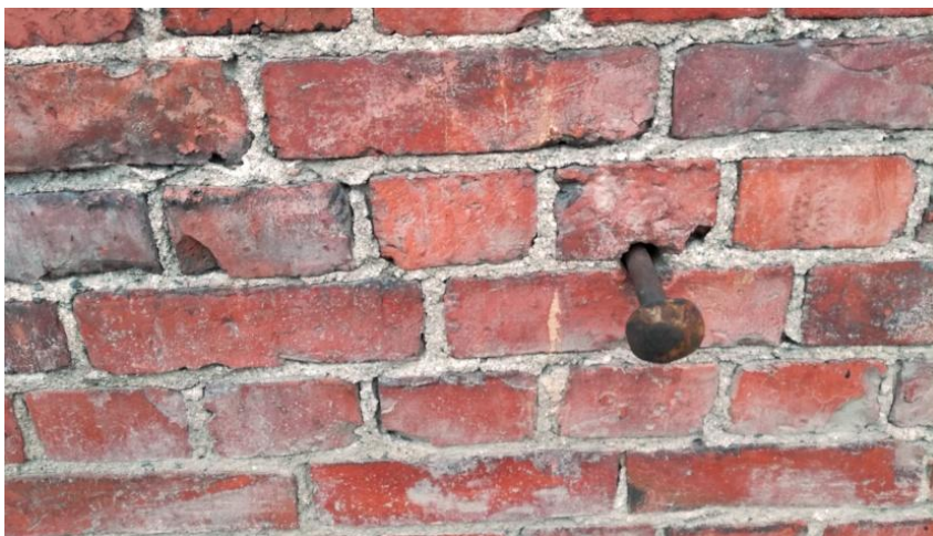
Kuva 10. Ruostuneet teräksiset tukiosat tiilimuurissa. Kuva: E. Kangas, 06.2017.
