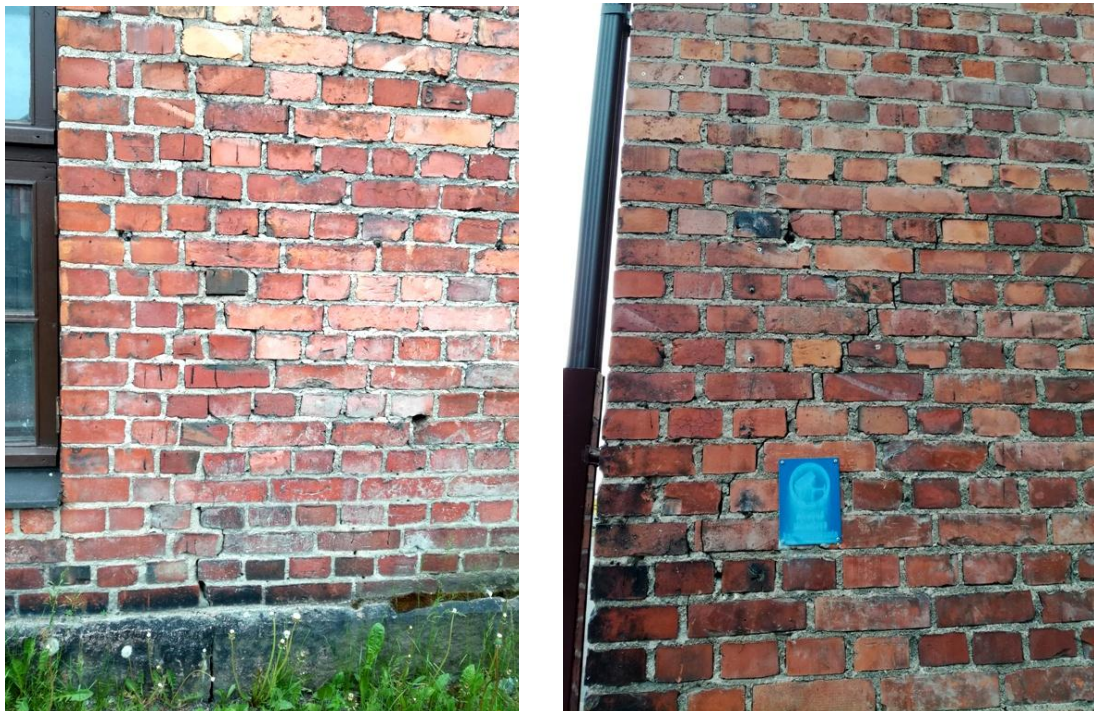
Kuva 6. Perustusten epätasaisesta painumisesta johtuvat halkeamat Riihimäen veturitallien tiiliseinissä. Kuva: E. Kangas, 06.2017.
