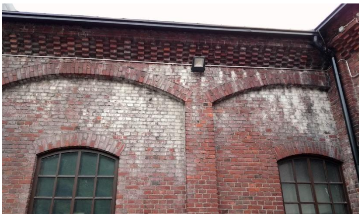
Kuva 7. Kiteytyneet suolat veturitalin julkisivuissa. Kuva: E. Kangas, 06.2017.
