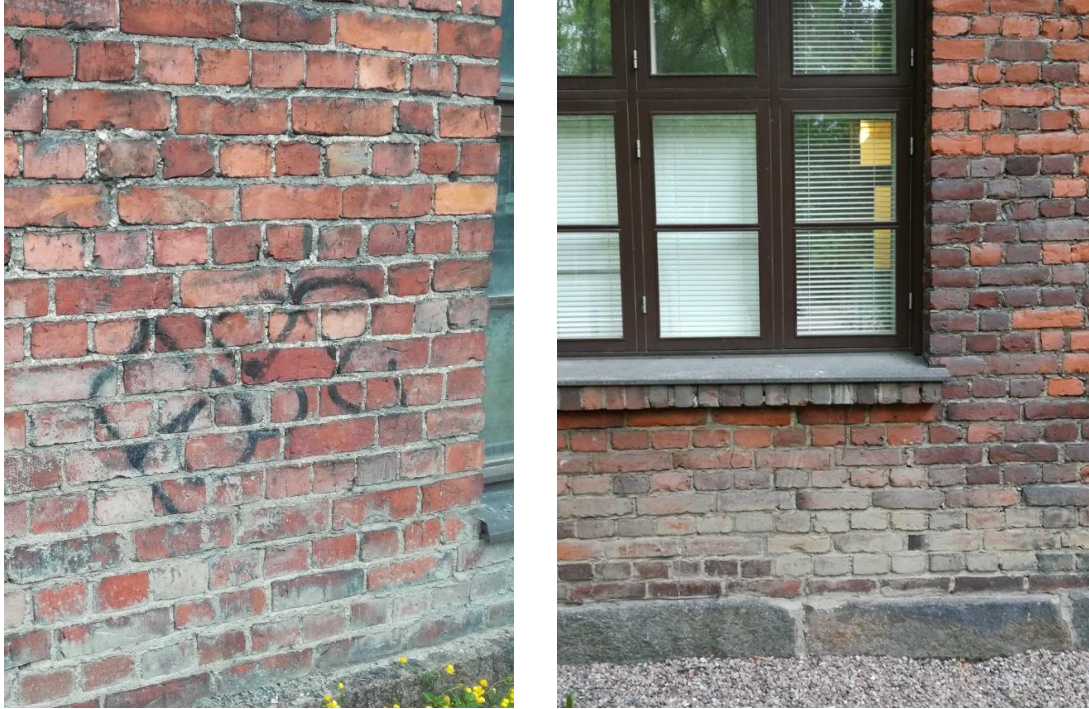
Kuva 5. Likaantuneet tiilijulkisivut. Kuva: E. Kangas, 06.2017.
