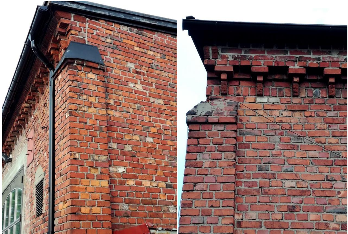
Kuva 15. Saman seinän toisessa päädyssä pilasterin pellitys puuttuu. Kuva: E. Kangas, 06.2017.
