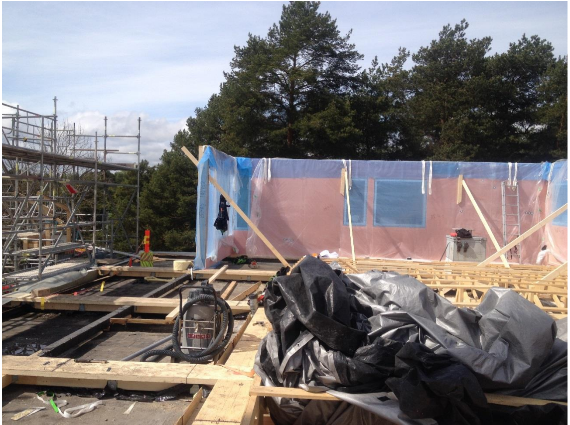
Kuva 6. As Oy Kuulaharjat; Elementtien asennusvaihe. Elementtiasennusteline vasemmalla sekä työnaikaisen sääsuojan kattotuolit ja kevytpeite edessä.
