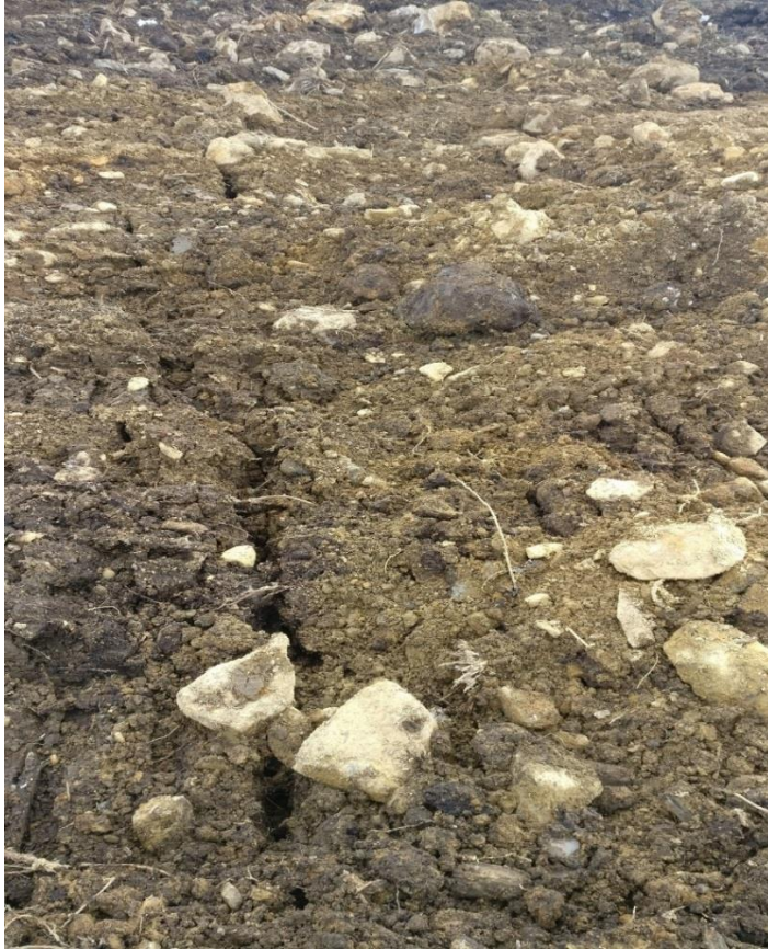
Kuva 19. Läjitysalueen kippauspaikan reunan sortumakohta
