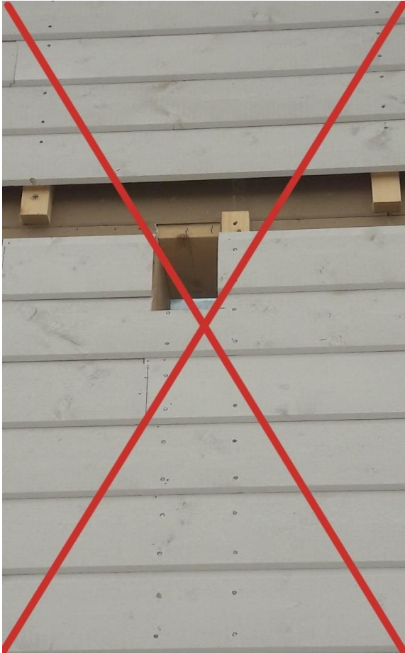
KUVA 9. Palkille tehtyä koloa ei ole suojattu viisto sateelta.
