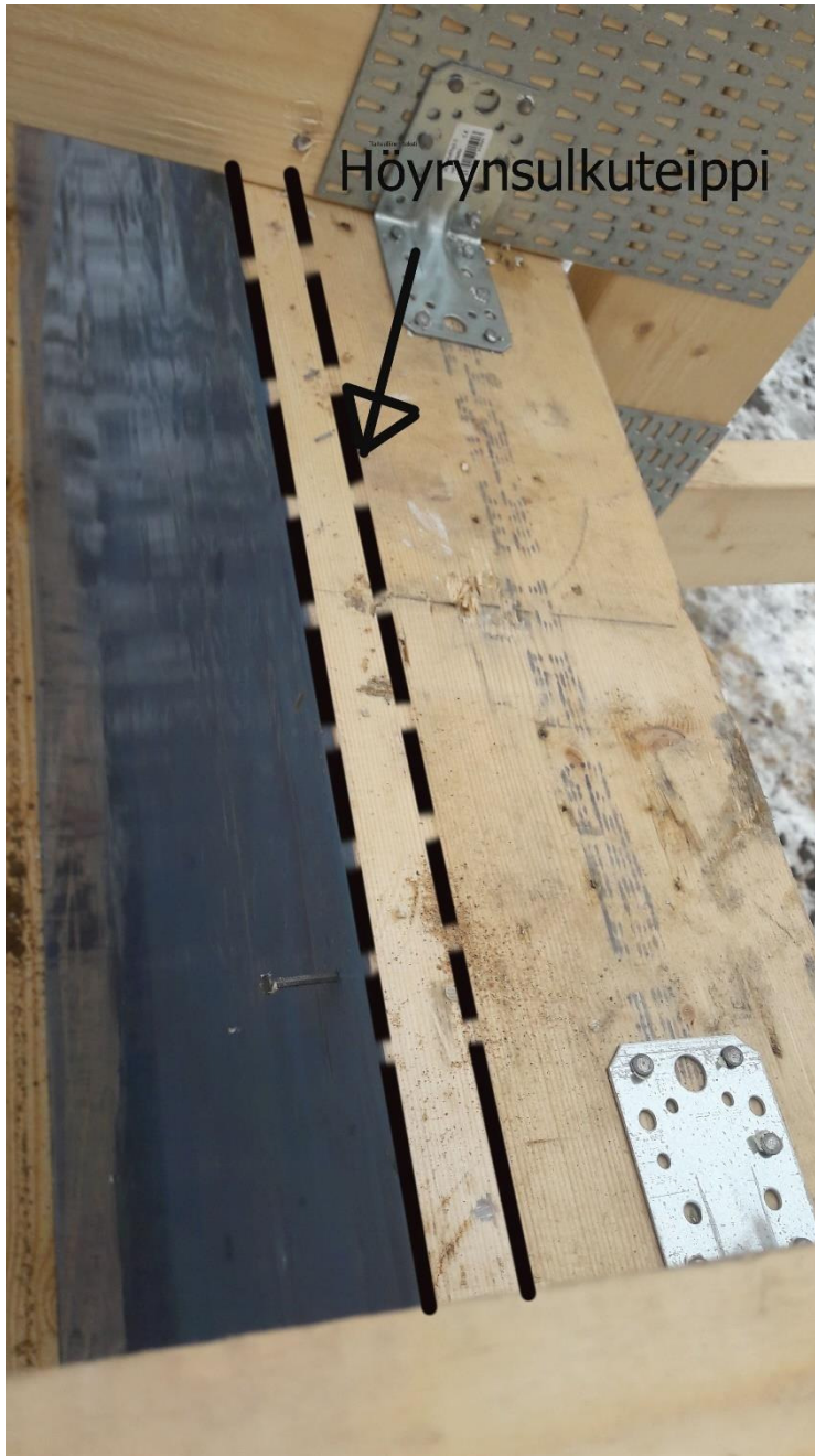
KUVA 8. Höyrynsulun yläreuna on teipattuna, mikä estää veden pääsemisen elementin sisälle.
