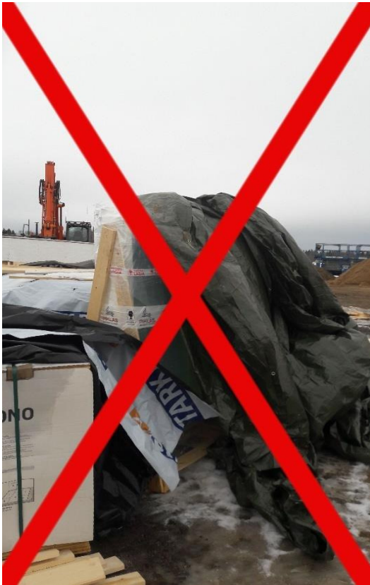
KUVA 4. Huonosti suojattu materiaali
