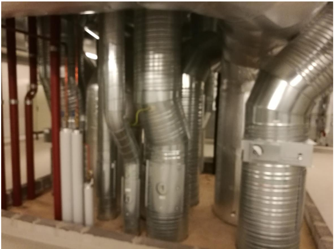
Kuva 3. Kuvassa olevat kanavat piti siirtää hormin poistamisen johdosta, mutta niitä ei ollut kuvissa piirretty. Tämän takia on hyvä käydä tutustumassa kohteeseen, jotta yllätyksiä ei pääse tulemaan.
