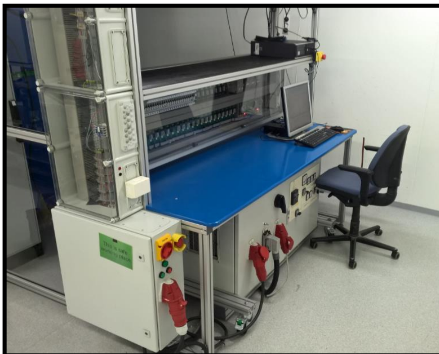
KUVA 28. Ohjauspöytä sisältää releitä ja erilaisia digitaalisia I/O –kanavia, joita voidaan käyttää esimerkiksi laitteiden ohjaamiseen (Kaunismäki, 2017.)
