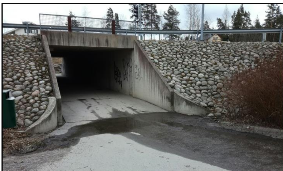
Kuva 46. Veden kerääntyminen alikulun suulle Siipoontiellä keväällä 2017.
