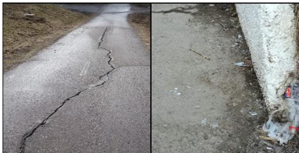
Kuva 28. Kaskitien alikulun pinnoitteessa ja kunnossapidossa havaittuja epäkohtia.
