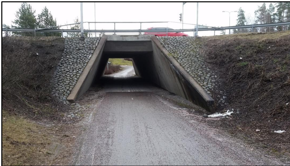
Kuva 34. Laurilantien alikulun länsipuolen suu ennen toimenpiteitä 4/2016.
