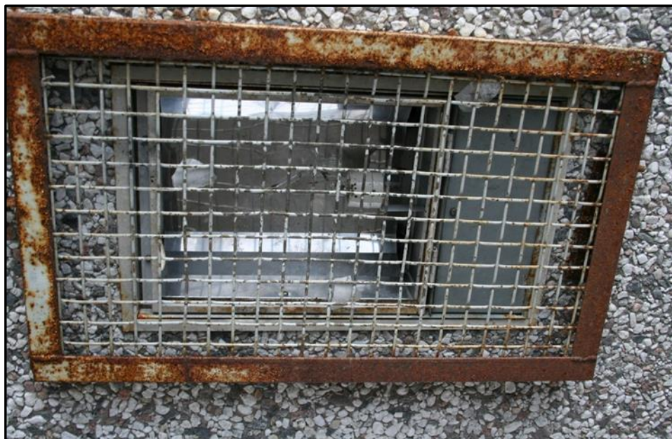
Kuva 41. Punajuurikujan alikulkutunnelin valaisimet olivat kaikki rikki 4/2016.
