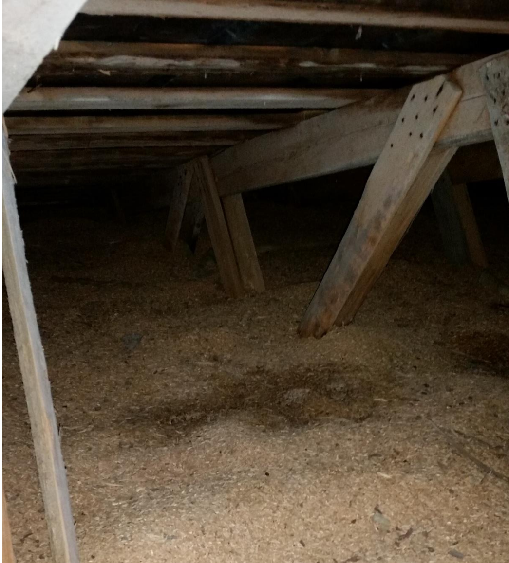
Kuvio 10. Kastunut lämmöneriste.
