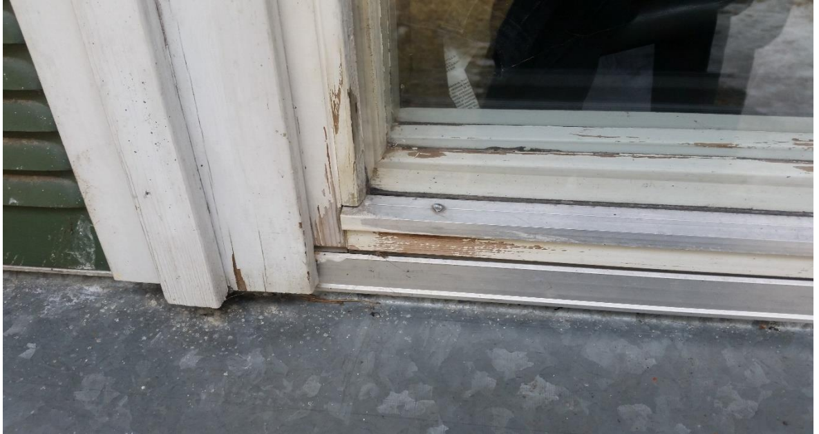
Kuvio 13. Puuikkunan karmin vaurio.
