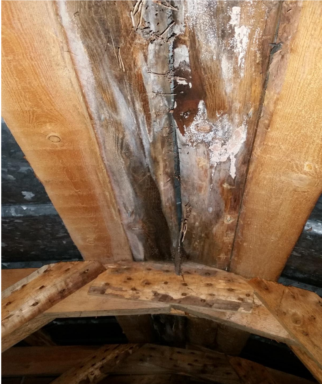
Kuvio 9. Aluslaudoituksen ja kattotuoliristikön kosteusvauriot.
