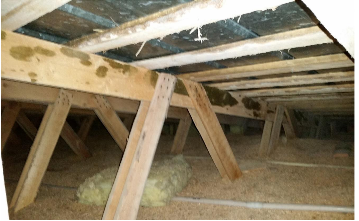
Kuvio 8. Kattotuoliristikon mikrobivaurio.
