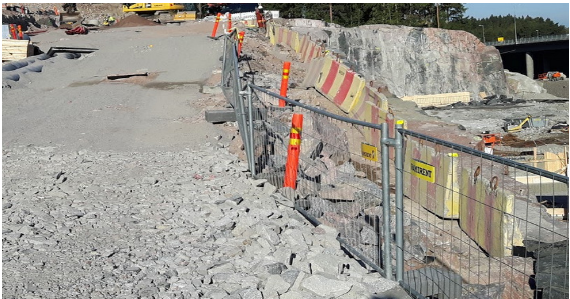
Kuva 12. Metallirakenteinen työmaa-aita sekä betoniset raskasesteet putoamisen estävinä rakenteina
