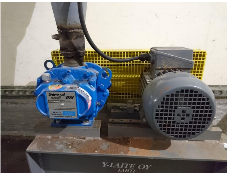
KUVA 10. Puhallin ja 1,5 kW sähkömoottori
