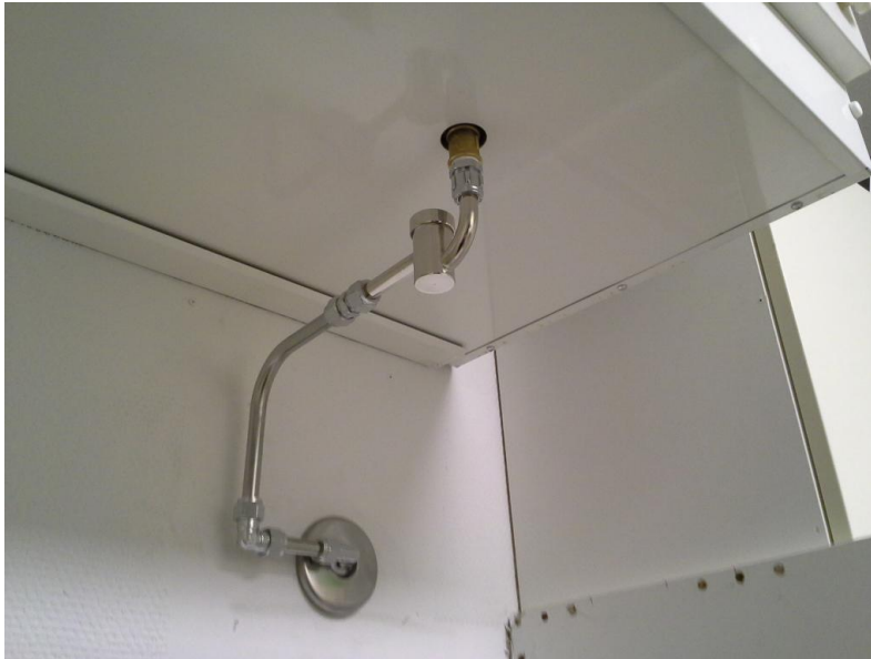
Kuva 2. Ilmanvaihtokoneen kondenssiviemäröinti pystyviemäriin poistokulmaan kytkettynä (6).
