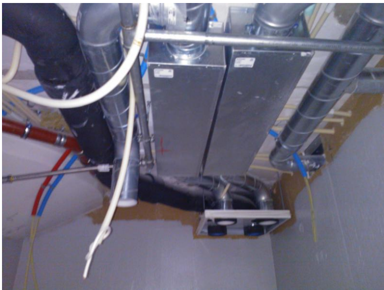
Kuva 5. Kylpyhuoneen kattorakenteisiin asennettuja ilmanvaihtokanavia.
