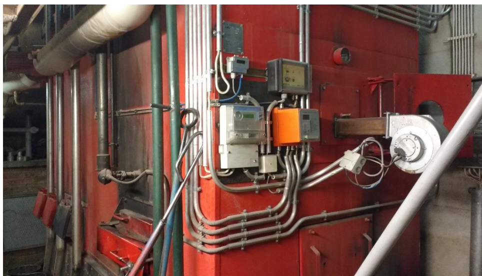
Kuva 11. Sulkavan keskuskoulun kellarissa sijaitseva lämmityskattila
