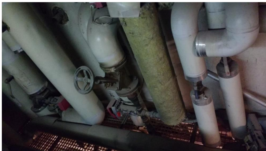
Kuva 12. Kaukolämpöveden sunntaus Sulkavan koulun lämmityspattereille
