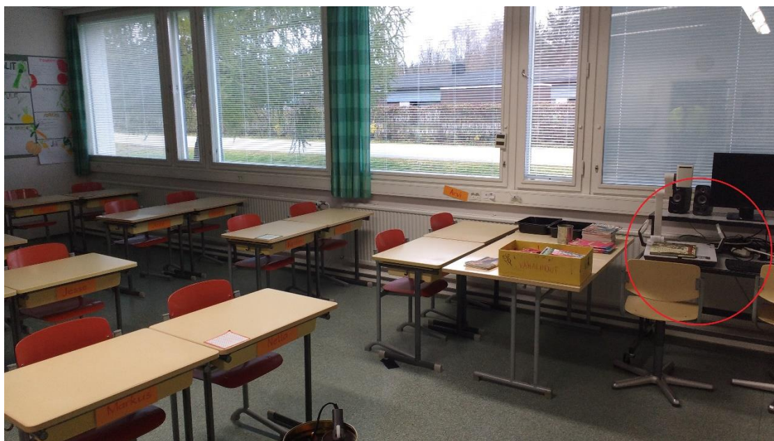
Kuva 12. Atk-pisteen taakse sijoitettu termostaattiventtiili
