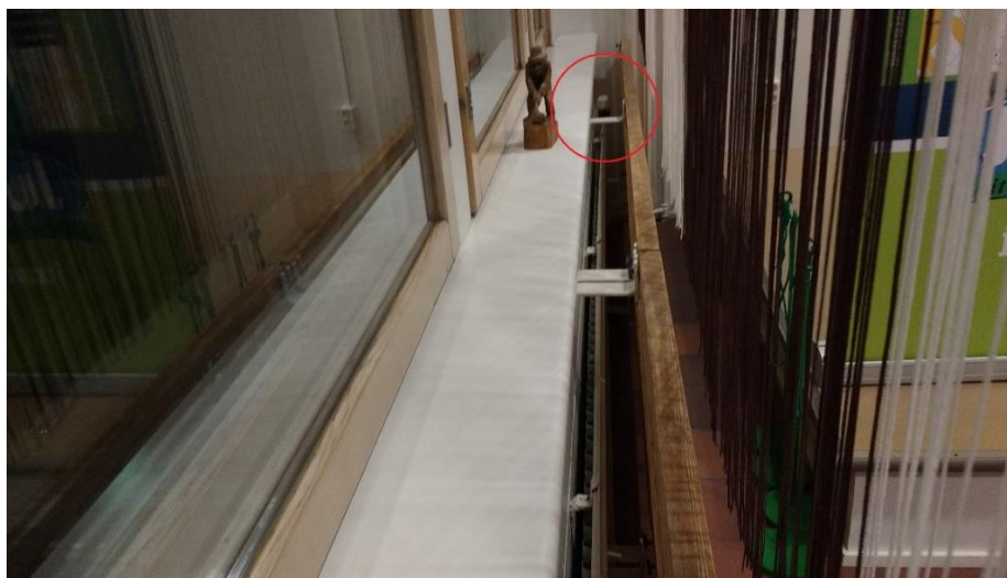
Kuva 9. Virheellisesti asennettu termostaatti
