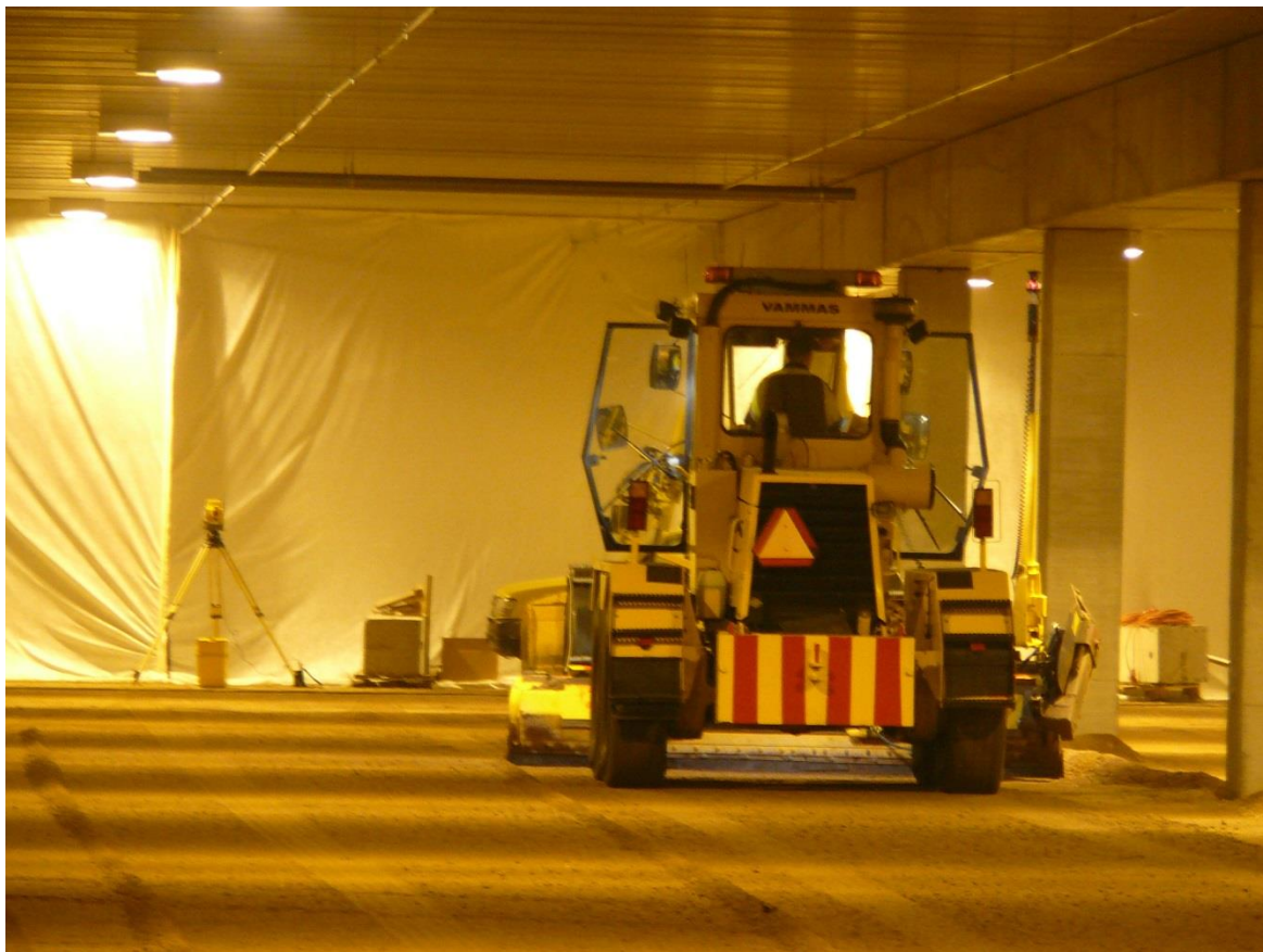
Kuva 19. Kuvassa tiehöylä työskentelee takymetrin seurannassa rakennuksen sisällä, jolloin GNSS-paikannuksen hyödyntäminen olisi mahdotonta. Takymetriohjaus mahdollistaa työskentelyn myös tunneleissa sekä alueilla, joilla katveet tai heijastukset heikentävät GNSS-signaalin tarkkuuta. (Hannuksela 2008)
