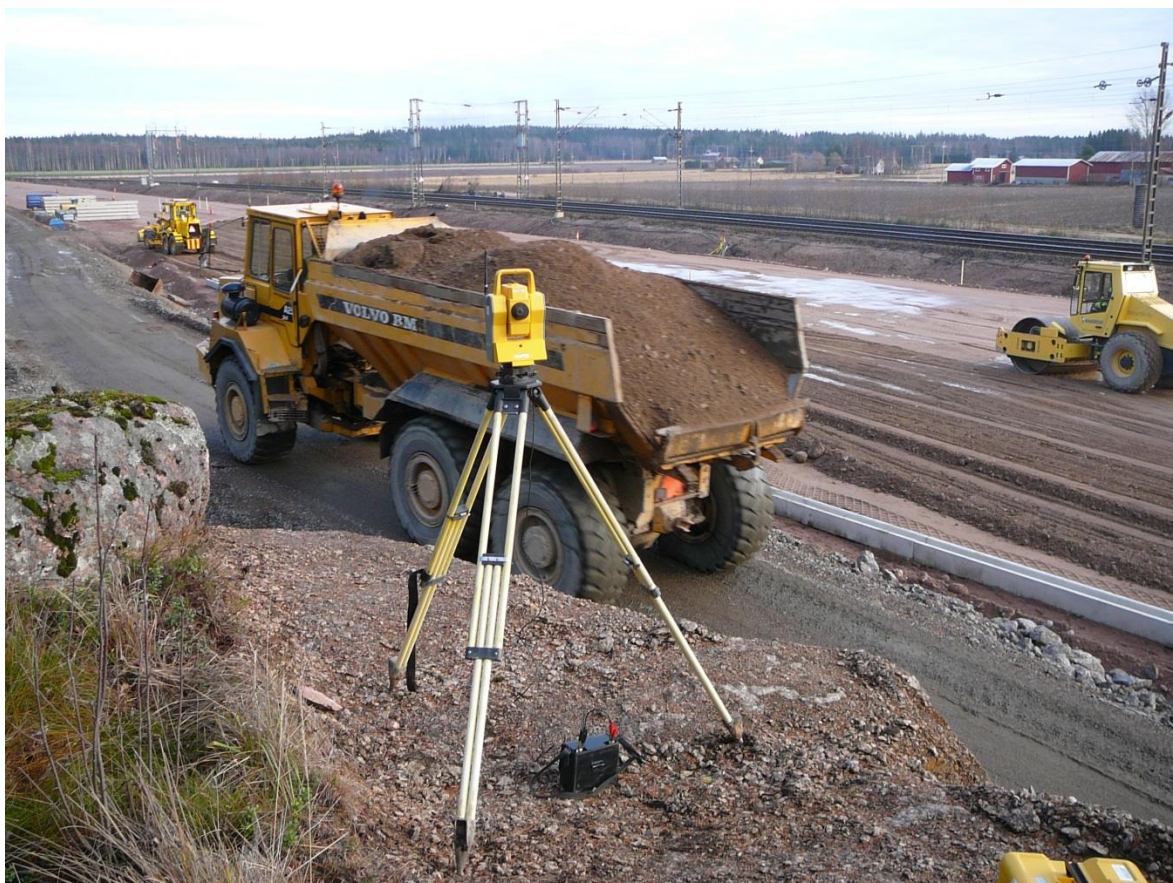
Kuva 18. Takymetriohjaus vaatii esteettömän näkymän seurannassa olevan työkoneen ja robottitakymetrin välille. Kuvassa työmaatieta ajava dumperi estää näköyhteyden, jolloin tiehöylän sijaintitieto katkeaa, eikä koneohjausta voida hyödyntää. Esteen poistuessa takymetri hakeutuu takaisin seurattavaan prismaan automaattisesti. Myös kuvassa oikealla näkyvän tiivistyskaluston on havaittu joissakin maaperäolosuhteissa aiheuttavan niin voimakasta värähtelyä, että takymetri lopettaa mittauksen, kojeen automatiikan havaitessa mittauservojen mahdollisen muutoksen. Esteiden ja tärinän aiheuttamia haittoja voidaan ehkäistä huolellisella työn suunnittelulla sekä hyvällä kojeaseman valinnalla. (Hannuksela 2008)
