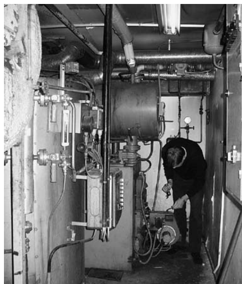
Kuva 1. Pannuhuonekäynnillä käydään läpi nykyinen lämmitysjärjestelmä laitteineen.
