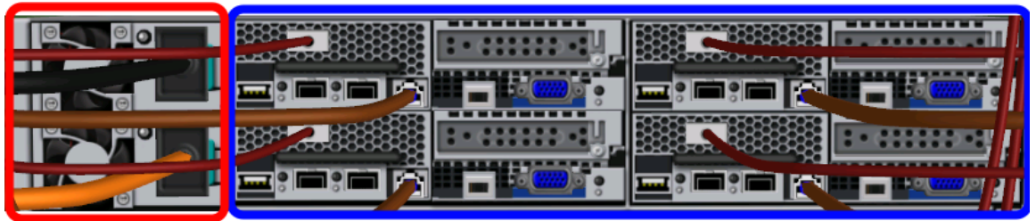
Kuva 8. iTRACSiin mallinnettu laite takaapäin sekä siihen kytketyt kaapelit.
