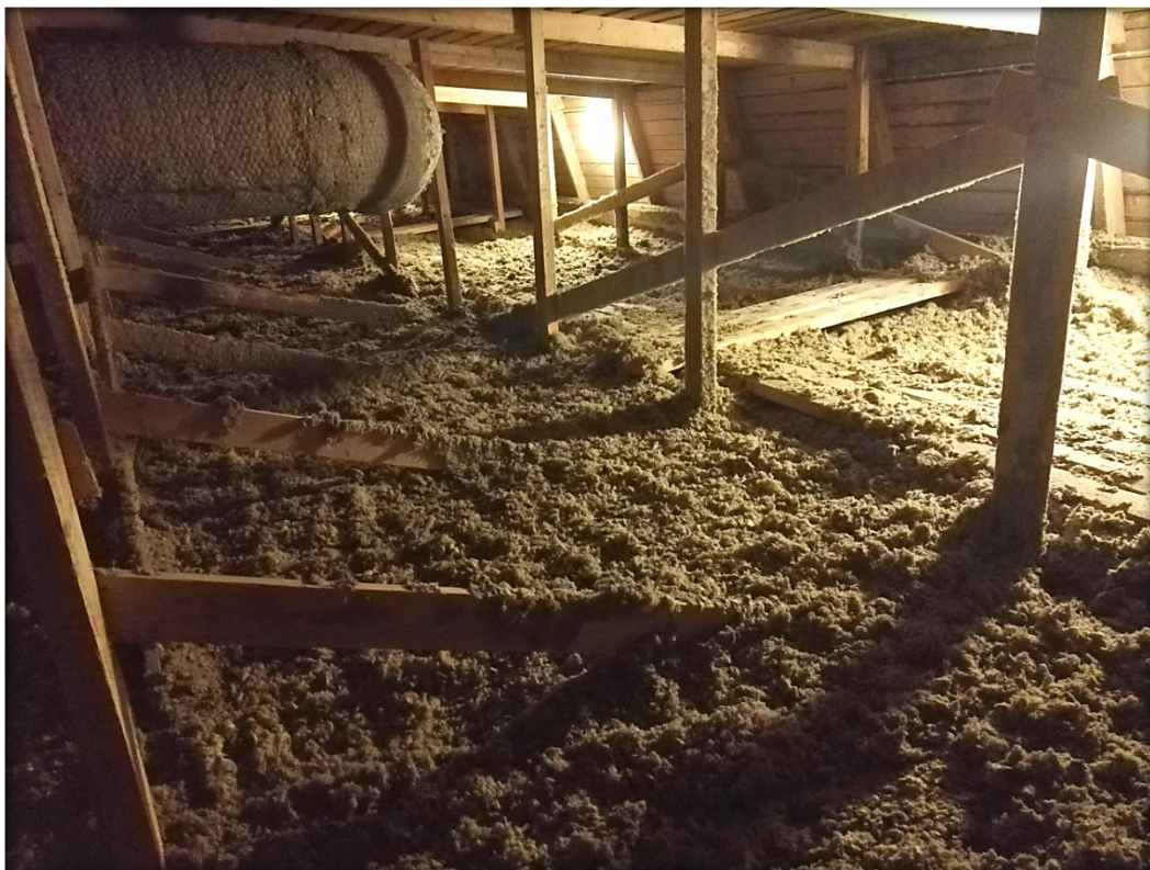
Kuva 13. Turun yliopiston Natura-rakennuksen ullakko. Lattia on täynnä kuitumateriaalia.
