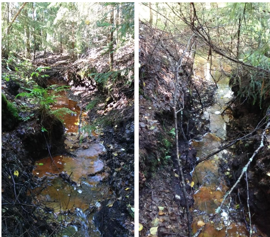
Kuva 35. Heikossa kunnossa oleva oja. (Kuvat: Sonja Pursiainen.)
