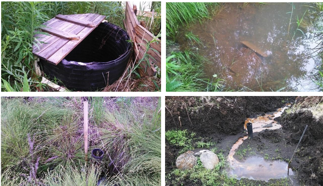
Kuva 25. Ylhäällä: Kasvettuneen altaan läheisyydestä oleva säätöpato ja sulku. Alhaalla: Tuotantoalueella olevia huuhteluputkia. (Kuvat: Sonja Pursiainen.)
