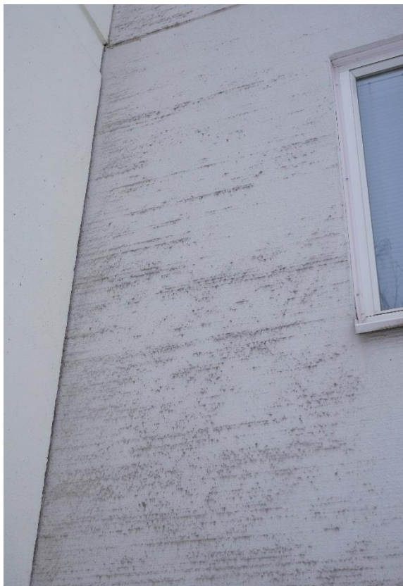
KUVA 15. Hilseilevää maalipintaa (Komulainen 2017)
