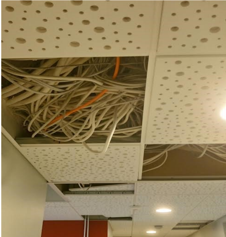
Kuva 16. Virheellinen ratkaisu kaapeleiden sijoittamisesta uloskäytävään
