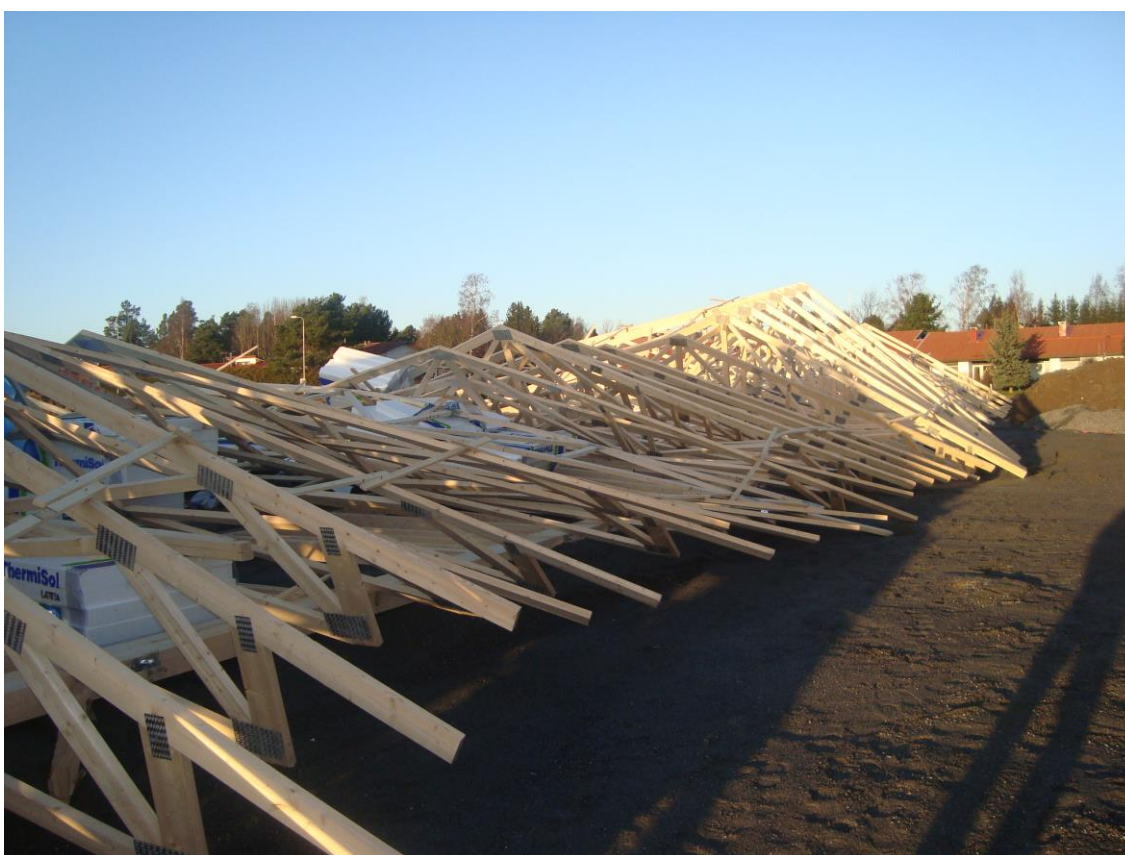
Kuva 1. Tapanimyrskyn joulukuussa 2011 kaatama rakenteilla olevan kahdeksan huoneiston rivitalon puurunko Porissa (Seppo Kivelä, 2011)
