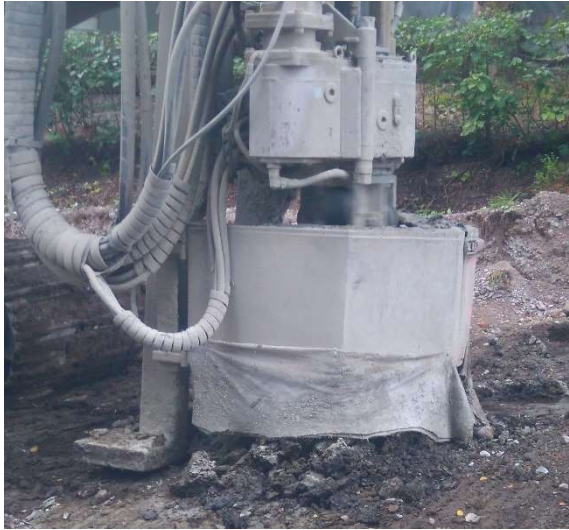
Kuva 3. Pilaristabilointikoneen sekoitinkärjen suojaus
