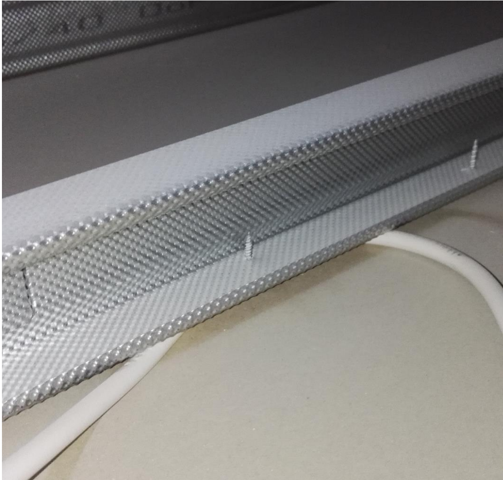
Kuva 4. Alakaton päältä otettu kuva, joka paljastui eristysresistanssimittauksia tehdessä.
